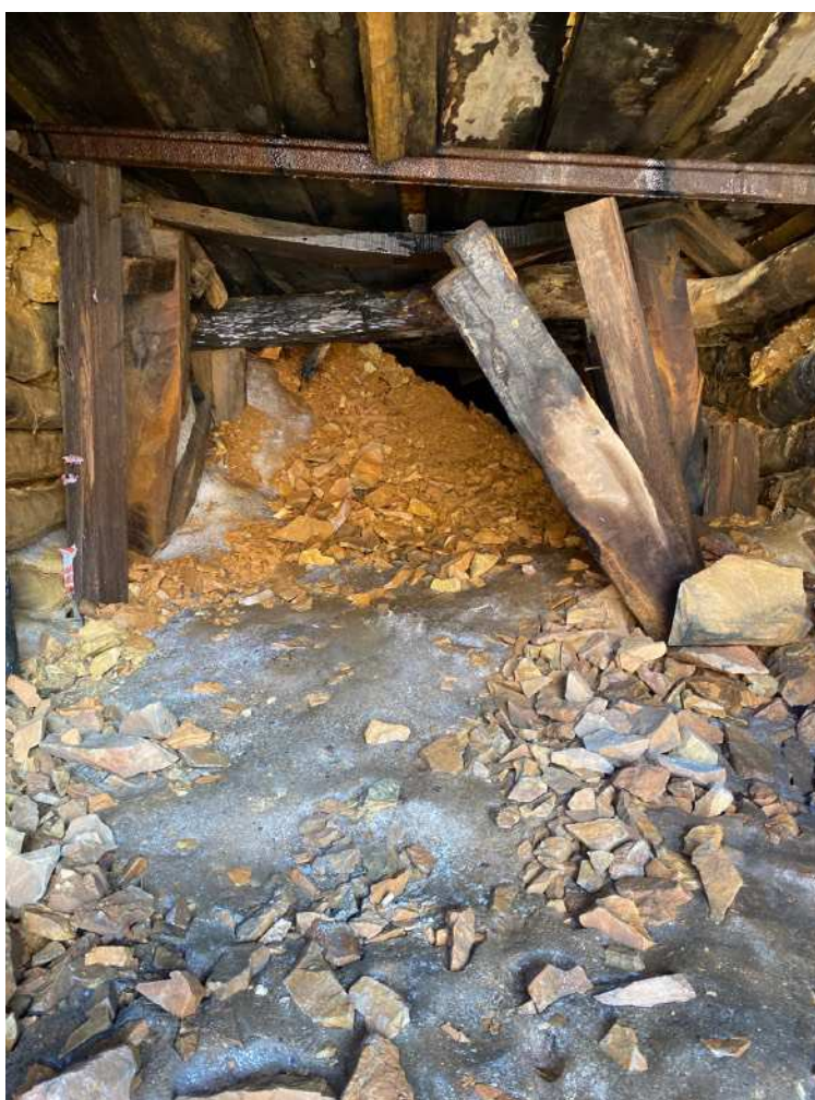
Fig. 45 : Vue de l'entrée de mine proche de la station 9 du téléphérique, aujourd'hui effondrée. On remarquera l'emploi de métal pour renforcer la structure en bois fragilisée, et la présence importante de glace, le cliché ayant été pris pourtant à la fin de l'été.
