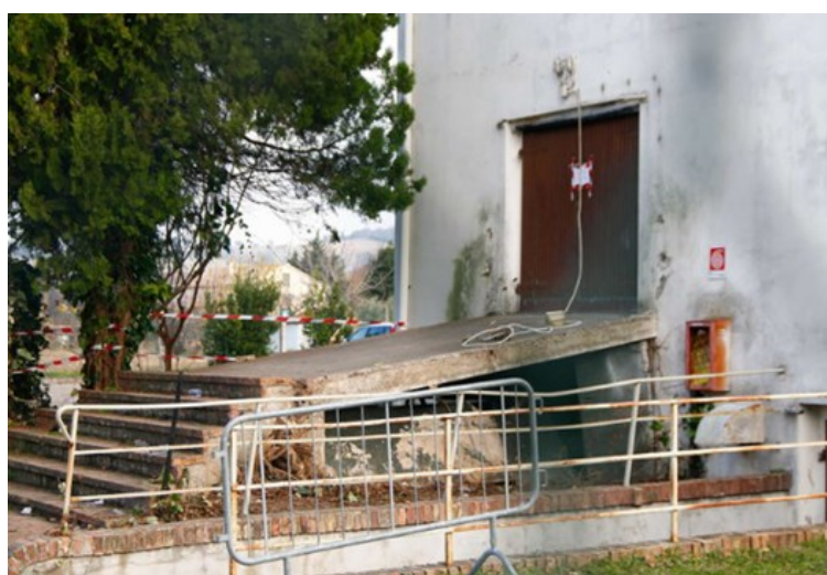
Figura 5 - Foto del ponticello dove è avvenuto il crollo del parapetto e la caduta delle persone 40
