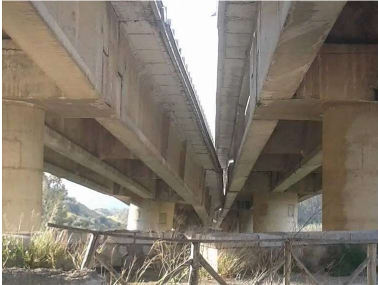
Figura 3.4 Spostamento laterale dell'impalcato del Viadotto Himeria ( www.meteoweb.eu )
