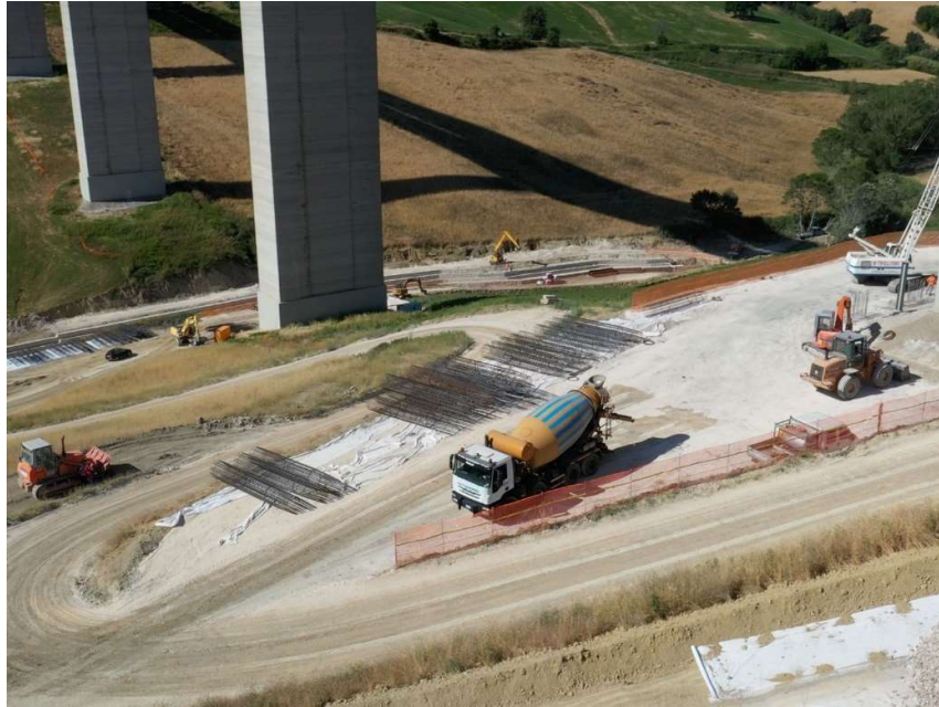
Figura 3.10 Interventi di miglioramento geotecnico e fondazionale sulle pile del viadotto Cerrano (zappabenedetto srl.it)
