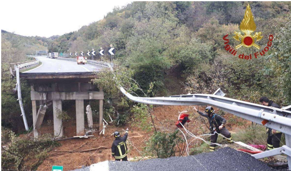
Figura 3.8 Danneggiamento del viadotto (Vigili del Fuoco)
