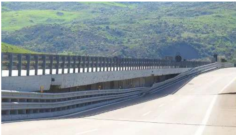
Figura 3.3 Abbassamenti differenziali del piano stradale del Viadotto Himeria (www.meteoweb.eu)
