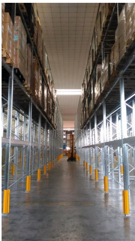
Figure 28 Scaffalature installate nel comparto A del magazzino
