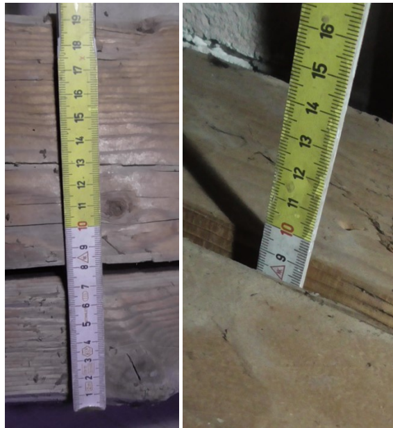
Fig. 3.11: Esempio di rilievo meccanico: apertura (sx) e profondità (dx) della lesione.
