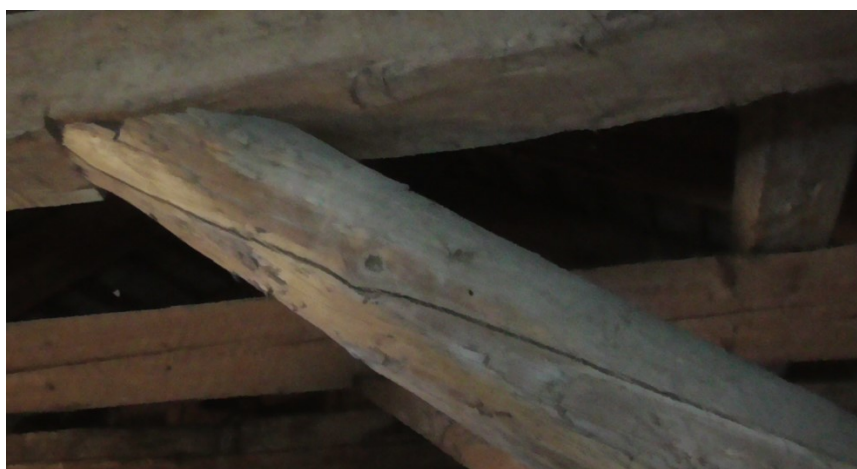
Fig. 3.12: Esempio di fibra ritorta rilevata a seguito di ispezione.
