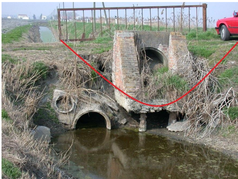
Foto 21: L'effetto della subsidenza: un vecchio sottopassaggio oggi completamente inutile perché sopra il livello dell'acqua. La linea tracciata in rosso indica il livello originale del fossato. Fonte: Camporese et al. , (2005)
