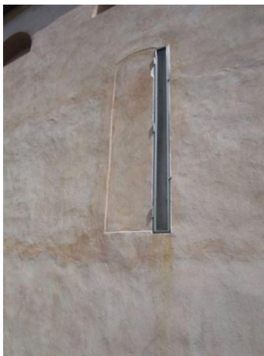
Particolare della fessura sul lato ovest dell'oratorio di Villa Bassi Rathgeb vista dall'esterno, XVIII secolo, Abano Terme, (PD)
