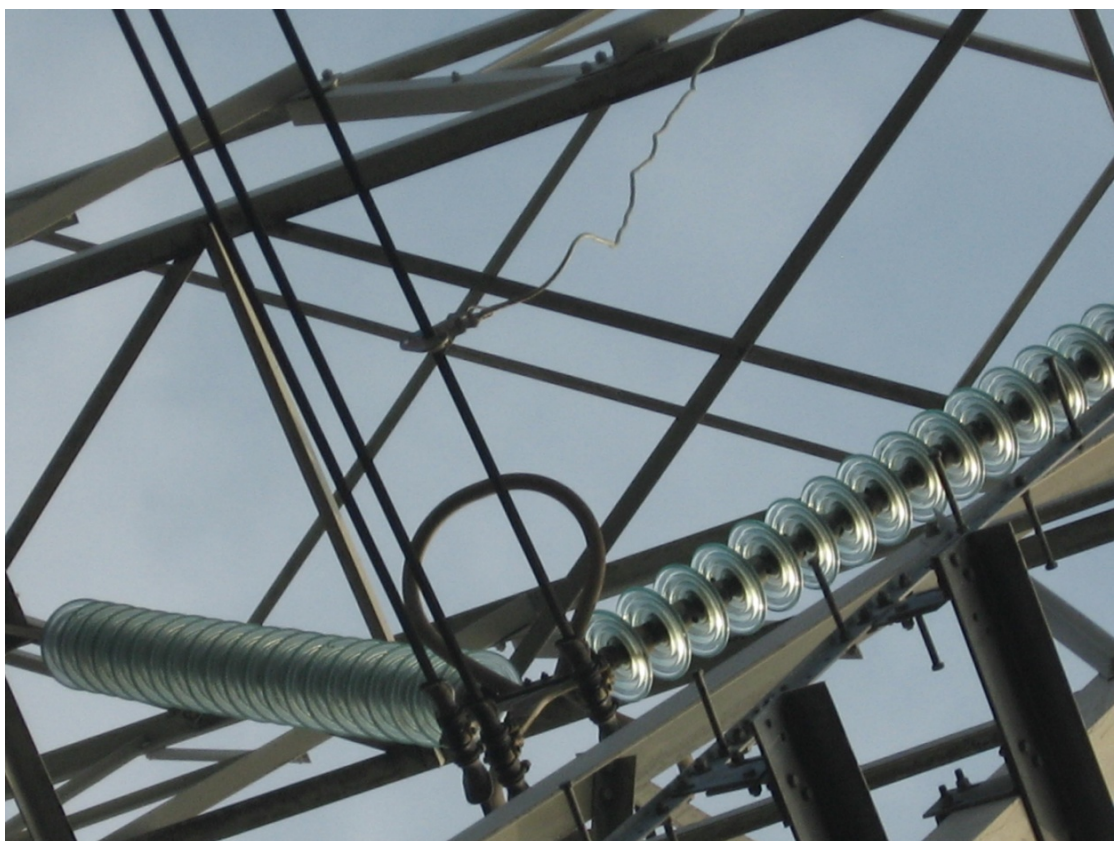
Messa a terra della linea Camin – Dugale
