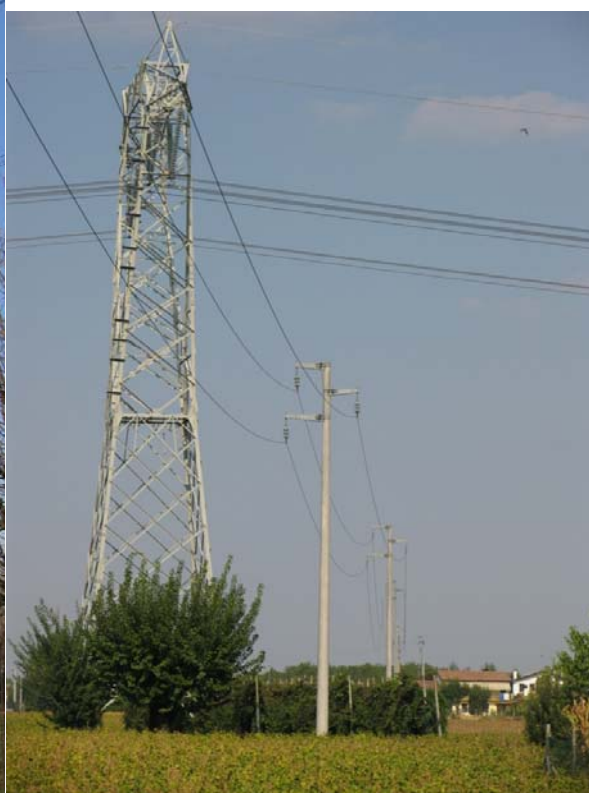
Sostegno 114 tipo VV24 con attraversamento MT situato su un vigneto
