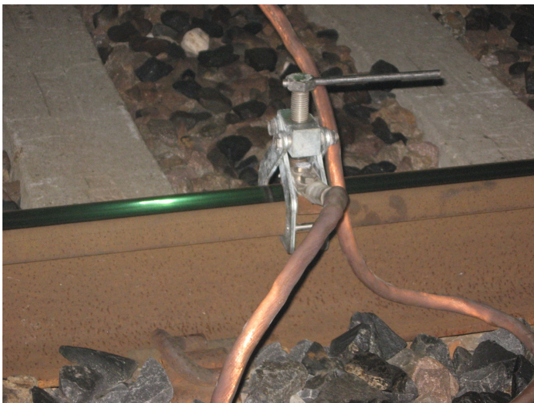
Messa a terra della linea FS
