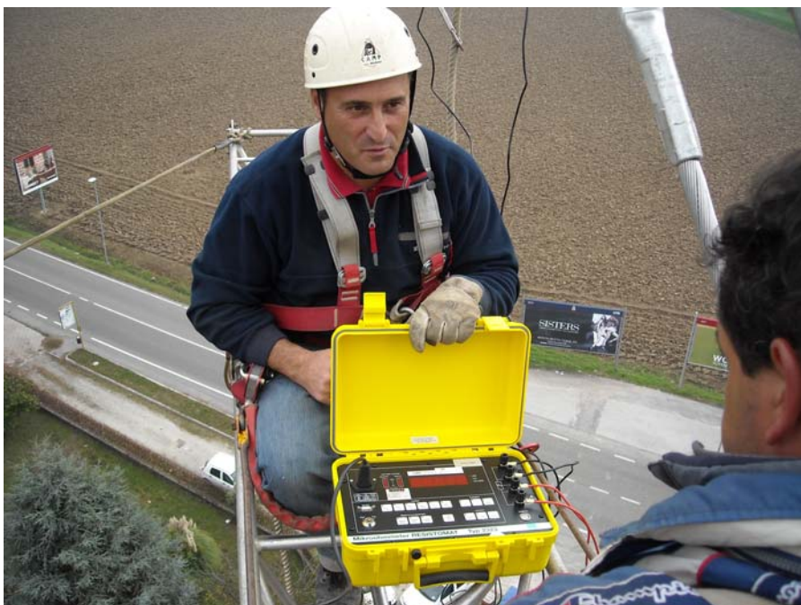
Misuratore micro ohmmetro con linea a 380 kV fuori servizio
