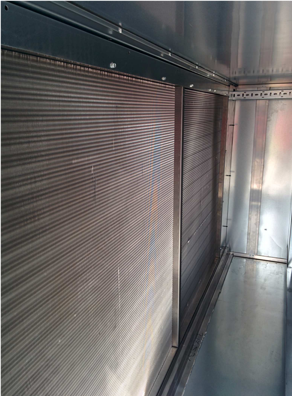
Figura 4.10 Vista della sezione centrale interna del gruppo frigorifero. Sulla sinistra vediamo la batteria di scambio termico, che produce l'effetto utile sull'aria ambiente da climatizzare.
