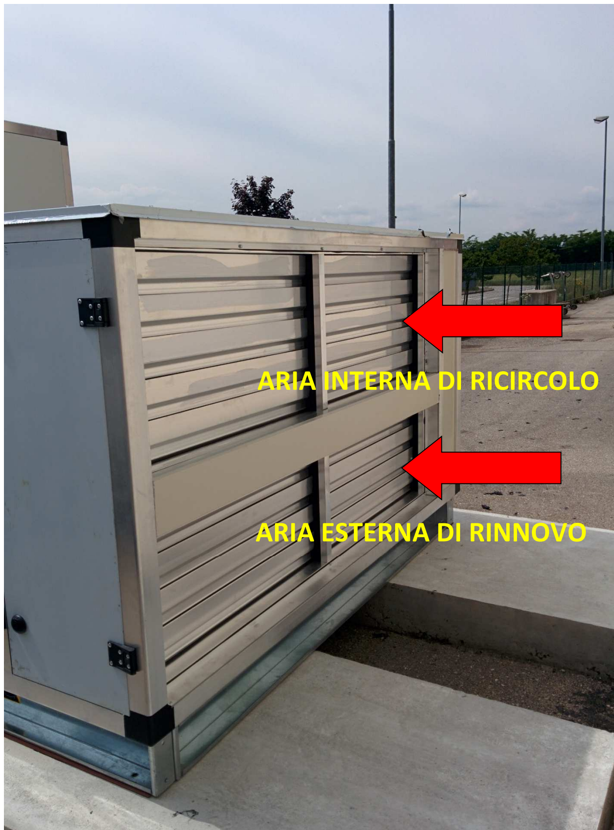
Figura 4.12 Dettaglio delle serrande di prelievo dell'aria proveniente dall'ambiente interno da climatizzare (serranda in alto) e dell'aria esterna di rinnovo (serranda in basso). La foto è stata scattata prima del montaggio delle opportune canalizzazioni; diversamente le serrande e soprattutto la separazione tra aria interna e di rinnovo, non sarebbero state visibili.
