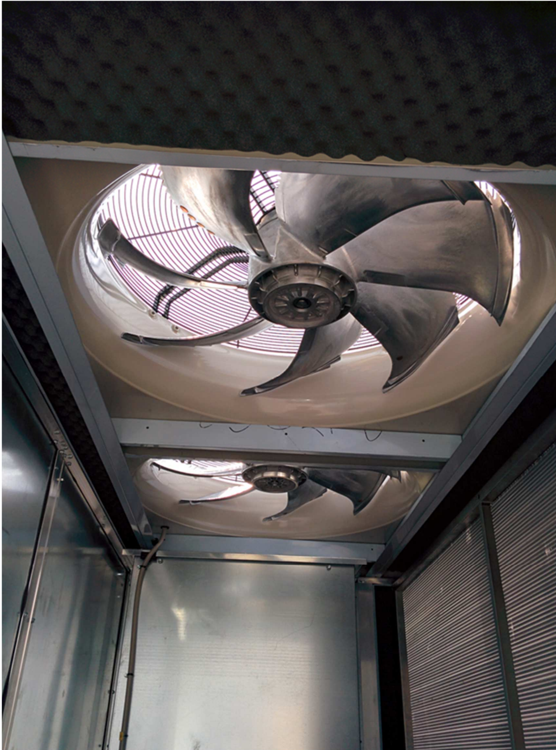
Figura 4.7 Dettaglio dei ventilatori assiali, per la movimentazione dell'aria esterna.
