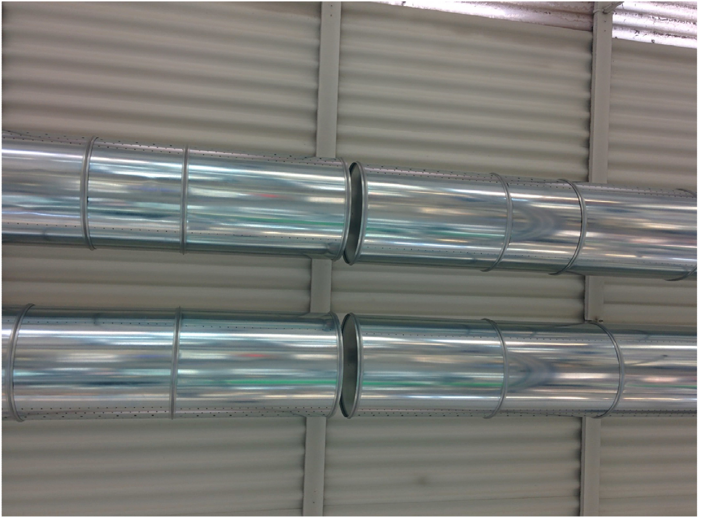
Figura 5.9 Arrivo dei canali di ventilazione al centro del reparto cucito. Ogni coppia di canali termina con dei moduli ciechi ed è alimentata da un gruppo frigorifero indipendente (28/04/2015).
