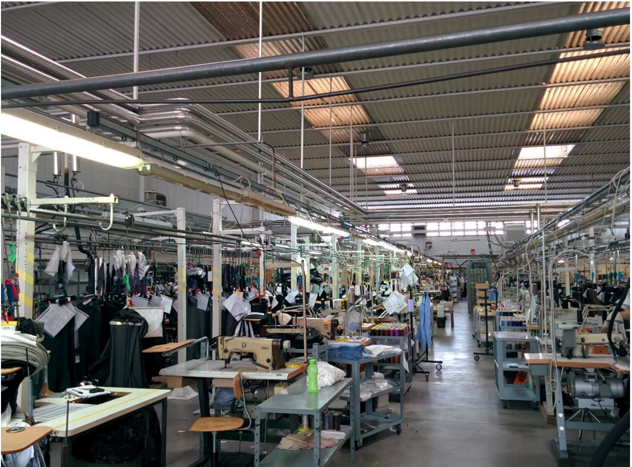
Figura 4.19 Foto “ex ante” la posa dell’impianto di distribuzione dell’aria primaria, rappresentativa della situazione a terra ed a soffitto dello stabilimento di produzione dell’azienda Tesina SRL, oggetto del presente lavoro di Tesi.
