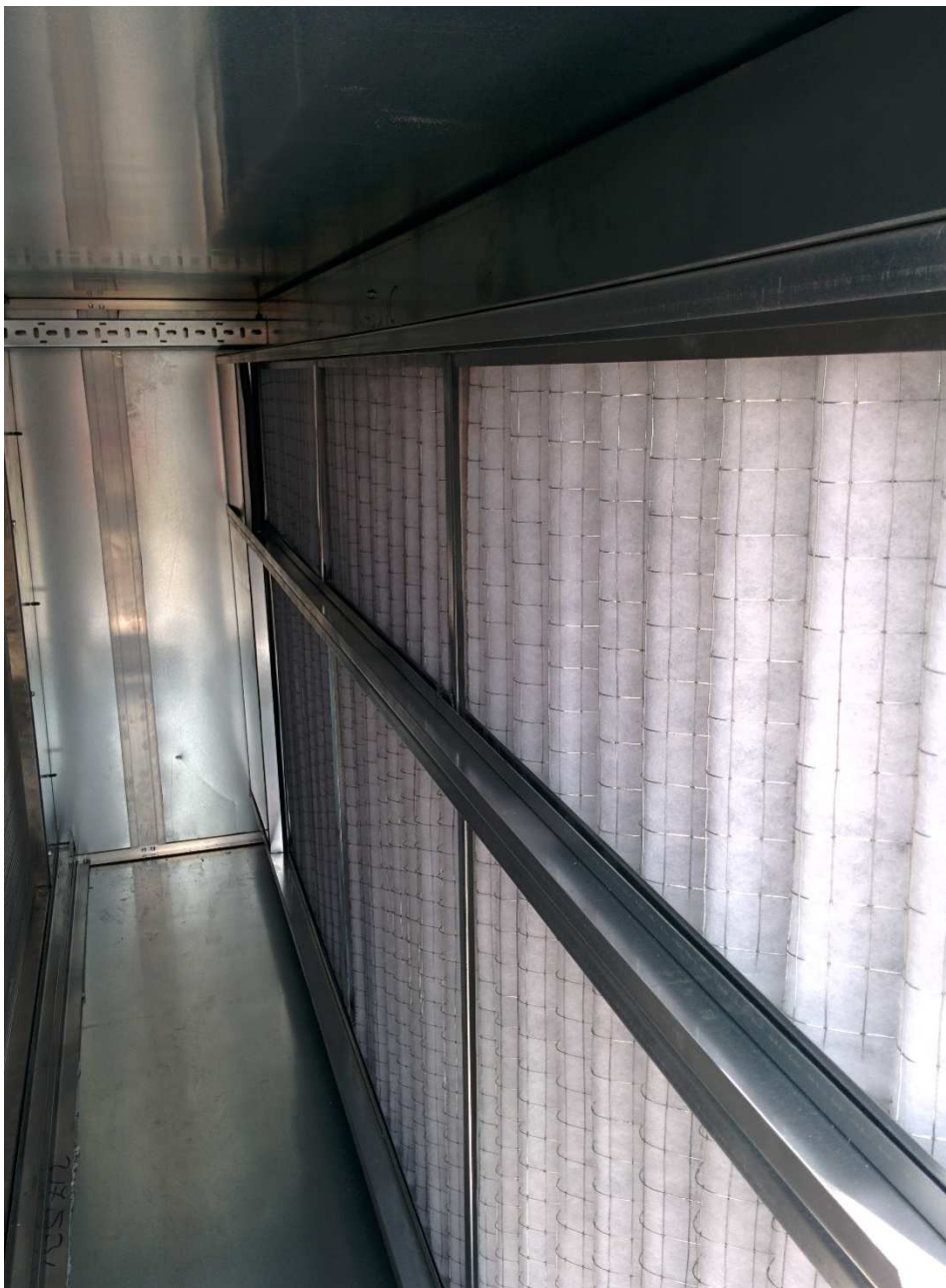
Figura 4.9 Vista della sezione centrale interna del gruppo frigorifero. Sulla destra sono visibili i filtri, estraibili a scorrimento per la loro sostituzione periodica.
