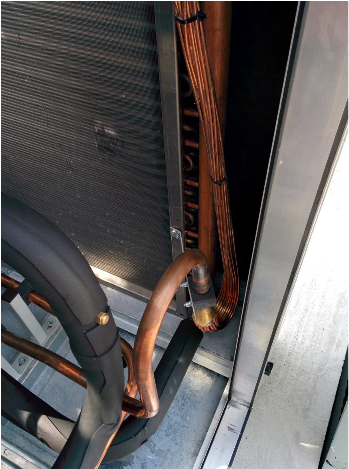
Figura 4.5 Vista dello scambiatore di condensazione/evaporazione a contatto con l'aria esterna.
