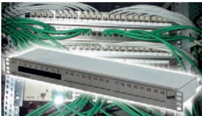
Fig. 6.8 – Dispositivo di protezione NET universale contro le sovratensioni per la protezione delle linee dati del quadro di piano.
