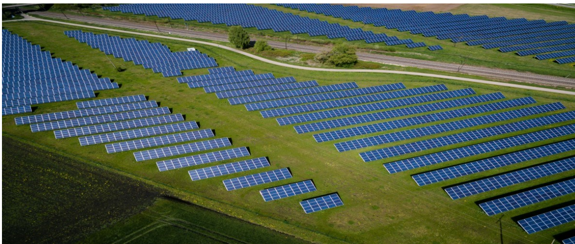
Fig. 5.8 – Impianto fotovoltaico a terra.
