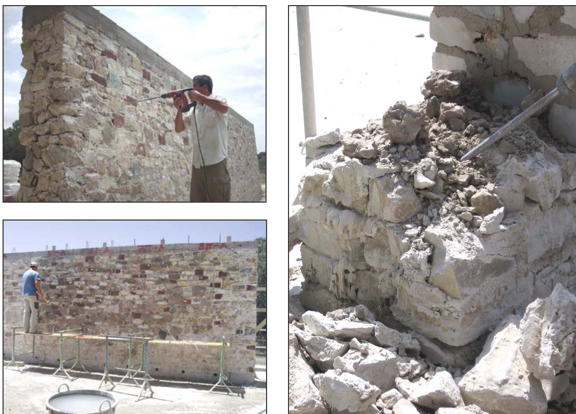
Fig 2.4: A sinistra esecuzione dei fori e dell'iniezione di malta a base di calce idraulica naturale; a destra dettaglio della sezione post-iniezione, durante il taglio dei pannelli.
