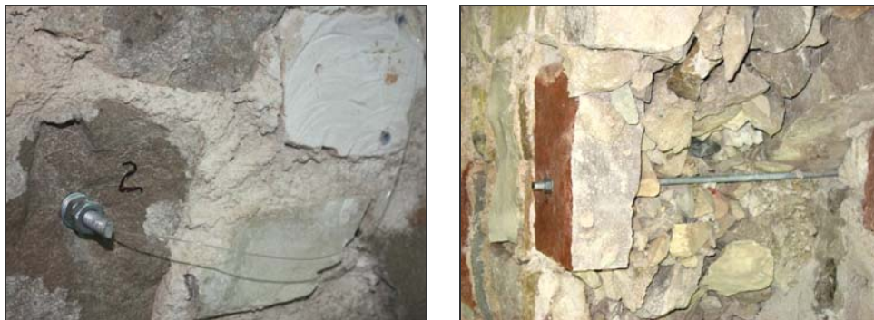
Fig 2.10: Posizionamento dei tiranti nella muratura: a sinistra vista esterna, a destra vista in sezione a seguito del collasso.
