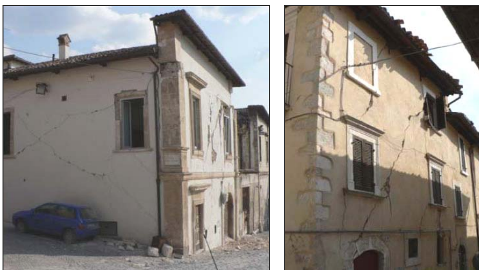
Fig 1.3: Alcuni dei meccanismi nel piano osservati nel centro storico de L'Aquila a seguito del sisma del 6 Aprile 2009. [Munari, 2010]
