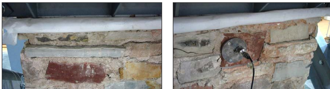
Fig 3.25: Pannello 4T. Rilievo fotografico dello spostamento relativo avvenuto sul retro a 0.40g.
