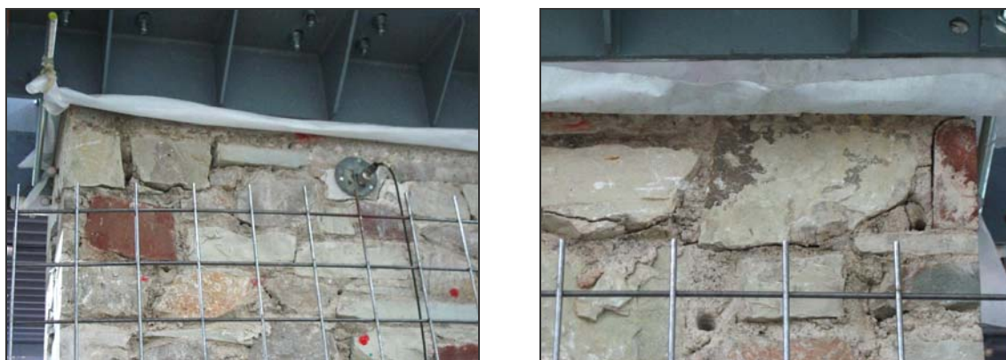
Fig 4.53: Fessurazioni sulla sommità dei pannelli 5I (a sinistra) e 6I (a destra) presenti sin dai passi di prova a PGA inferiori.
