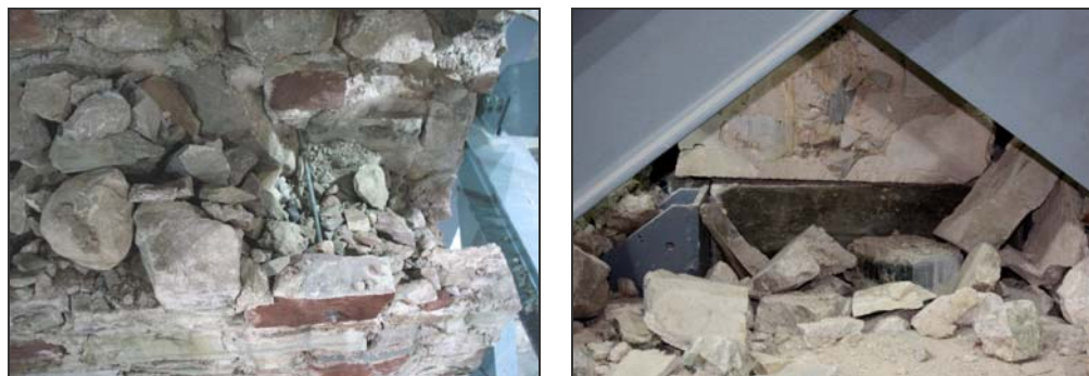
Fig 3.18: Pannello 3T. Rilievo fotografico del collasso, particolari del tirantino e del basamento.
