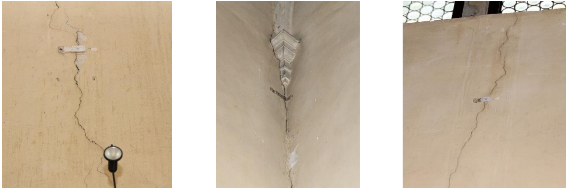
Figura 3.1: Alcuni dei fessurimetri presenti a cavallo delle lesioni della navata centrale.
