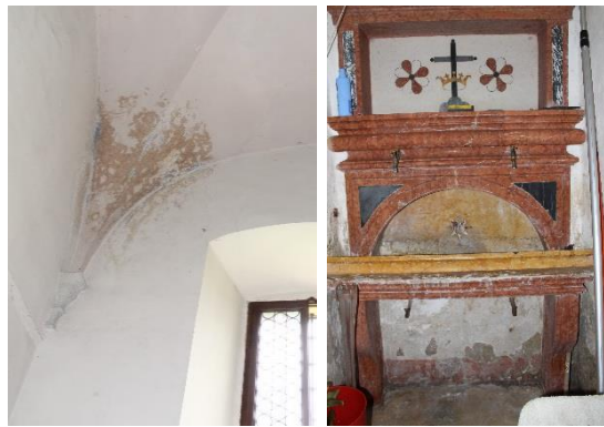
Figura 3.12: Distacco dell'intonaco all'interno della chiesa.
