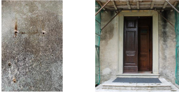
Figura 3.15: Macchia causata da sostanza rugginosa sulla facciata ovest e macchia causata dalla presenza dell'impalcatura sulla facciata est.
