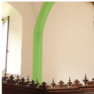
Figura 3.30: mancanza di ammorsamento pareti interne sagrestia
