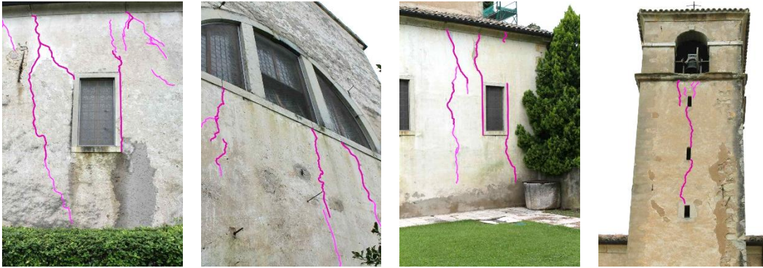
Figura 3.4: Lesioni, nell'ordine, sul prospetto nord, ovest, est della chiesa e sud del campanile.
