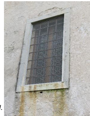
Figura 3.10: Colatura su una finestra del prospetto nord.
