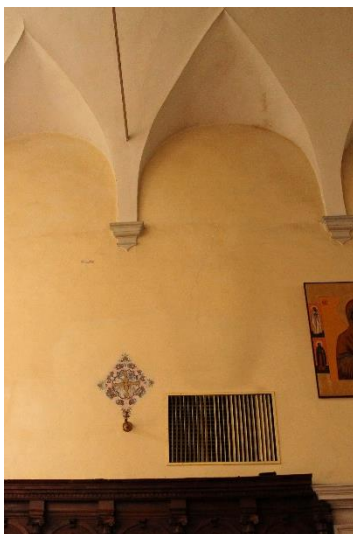
Figura 3.29: Griglia di ventilazione navata centrale.
