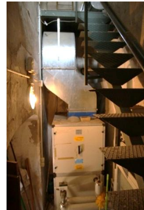
Figura 3.28: Impianto trattamento aria nella stanza di accesso al campanile.
