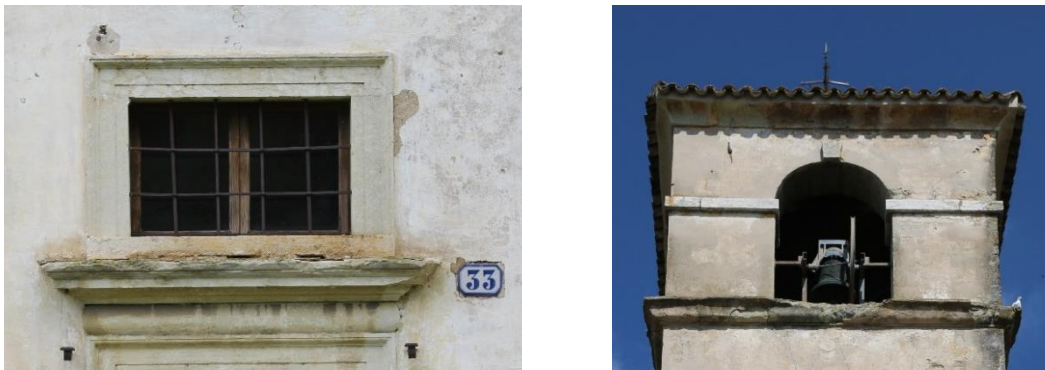
Figura 3.16: Dettagli di mancanze nei cornicioni.
