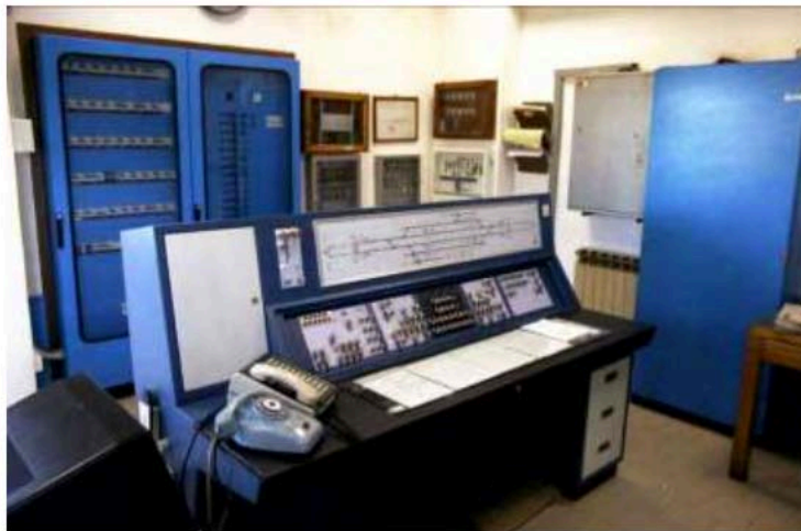
Figura 53 - Banco di manovra ed armadio di un ACEI
