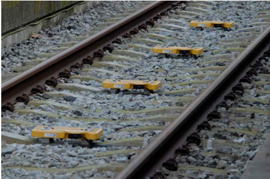
Figura 65 - Alcune balise installate lungo i binari
