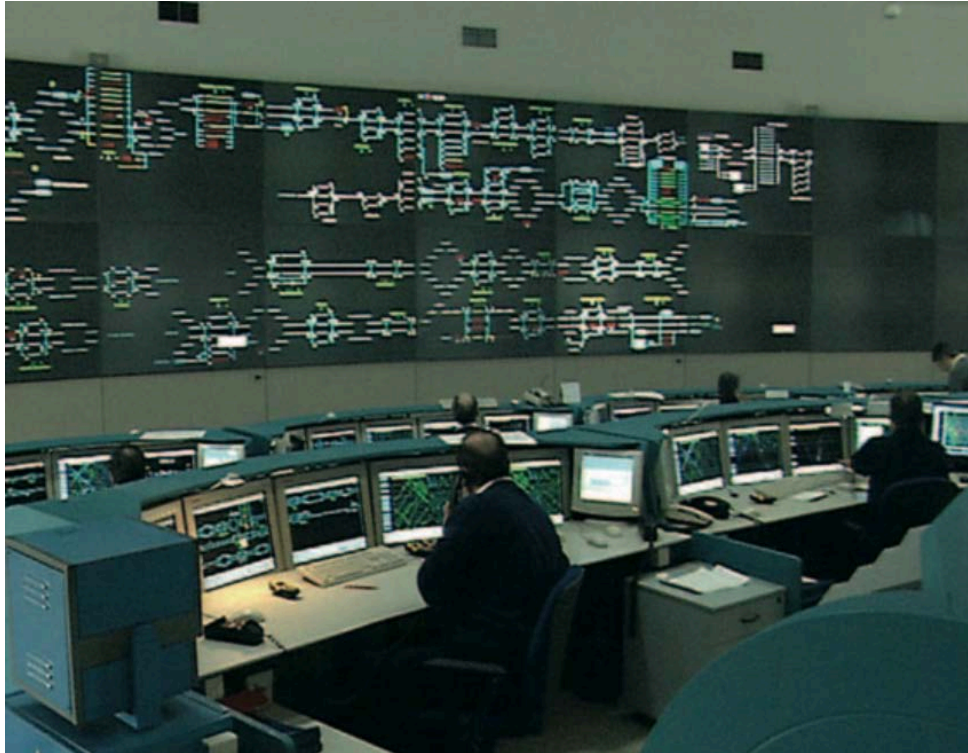
Figura 50 - Esempio di sala di controllo per la supervisione della circolazione ferroviaria
