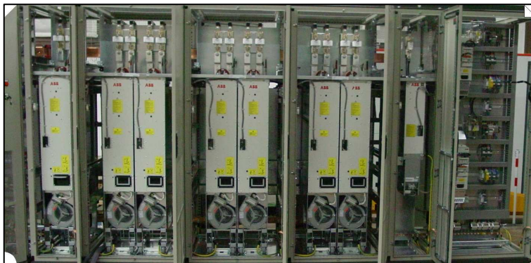
Fig. 7.1.1.1 – Quadro elettrico con la presenza di inverter
