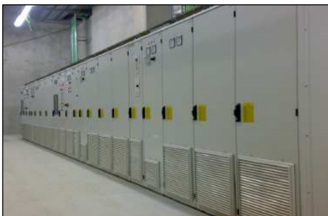
Fig. 1.2.2 – Esempio di fornitura in B.T.
