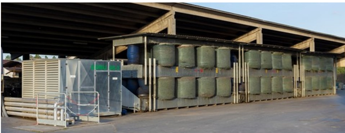
Figura 2.9 - Impianto di essiccazione a doppia ventilazione (CLIM.AIR 50).
