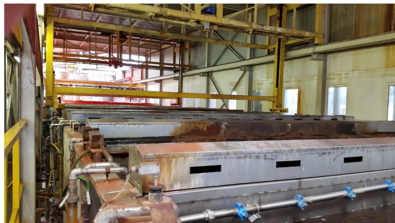
Foto sopra: esempio di impianto libero da bilancelle
