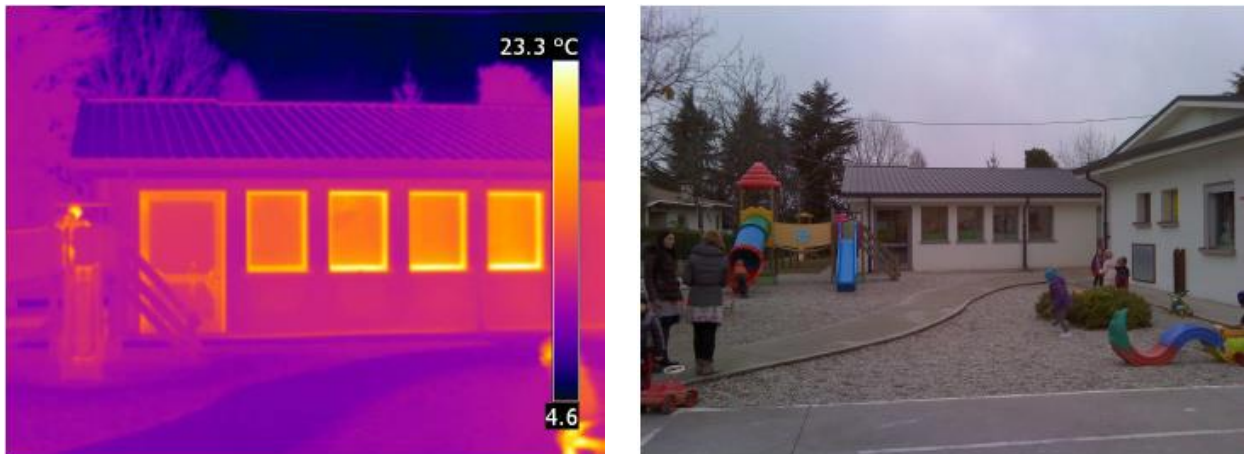
Fig. 49: Immagine n° 01 della Termografia
