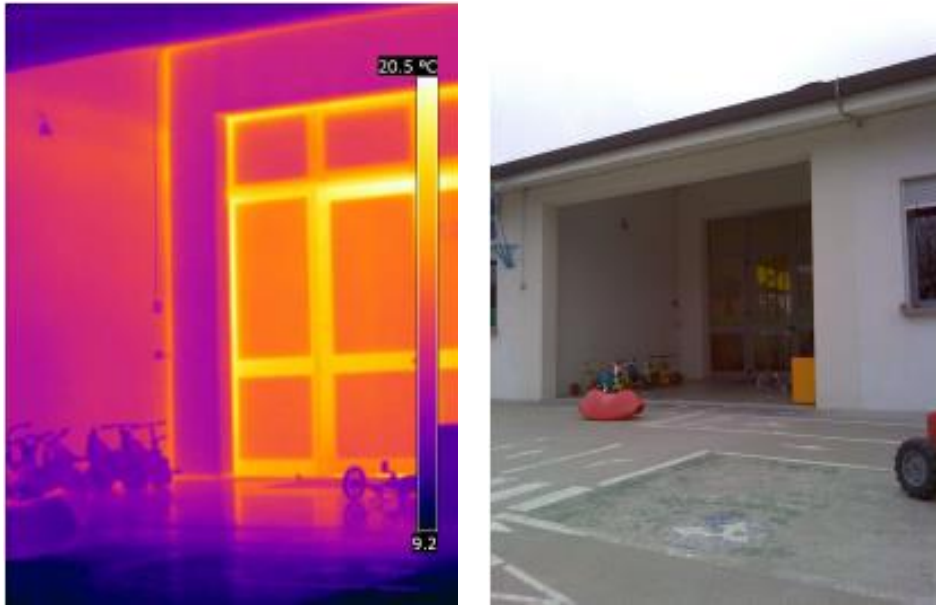
Fig. 51: Immagine n° 03 della Termografia
