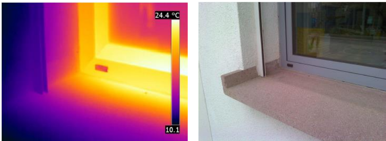
Fig. 52: Immagine n° 04 della Termografia
