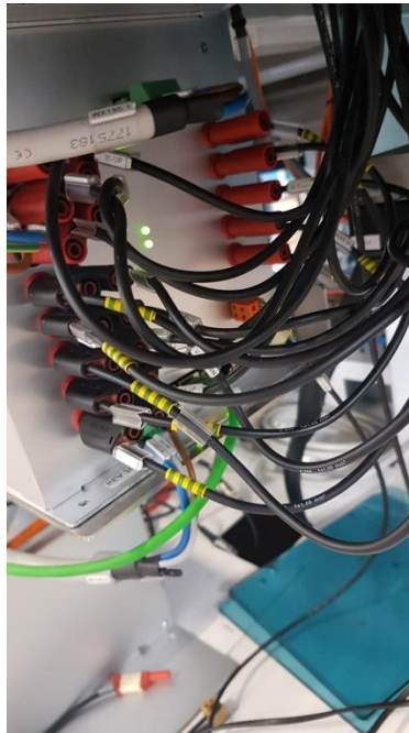
Figura 3.4: carico elettronico collegato al sistema di contattazione
