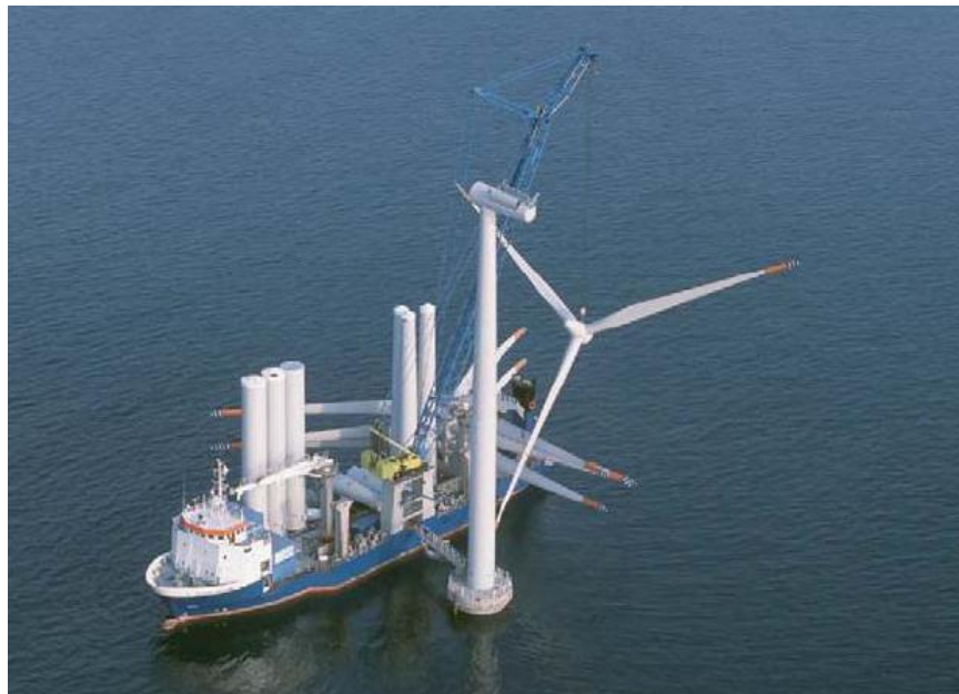
Figura 2.8: Gru su chiatta di servizio durante le operazioni di montaggio delle componenti superiori della turbina eolica: torre, navicella e rotore.
