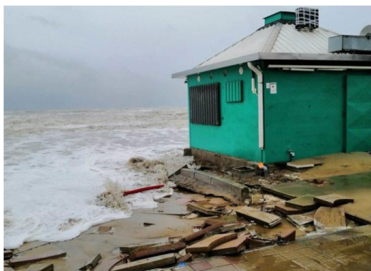
Figura 48 a sx: Danni sulla spiaggia durante l'evento del 17/11/2019 (da Eco Vicentino)
