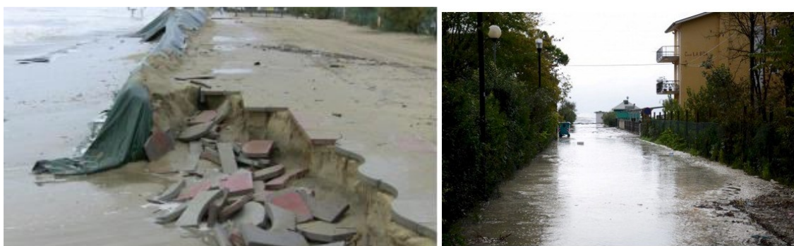
Figura 41 a sx: Erosione localizzata durante l'evento del 06/11/2000 (da Piano delle Acque del Comune di Jesolo), a dx: allagamento durante l'evento del 1/11/2012 (Fonte https://www.claudiovianello.it/ )
