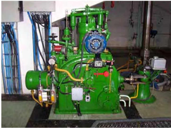
Figura 7. 4 Regolatore di velocità oleodinamico della centrale idroelettrica del Furlo lungo il fiume Candigliano. Fonte www.educambiente.it
