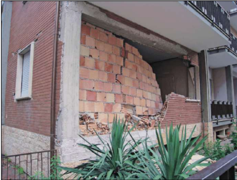
Figura 18: Degrado dal sisma su muri in laterizio
