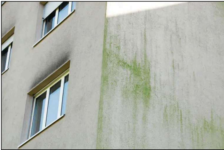
Figura 17: Degrado del sistema a cappotto
