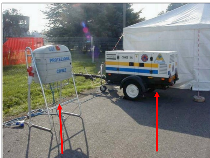
Figura 8: "Quadro elettrico generale e gruppo elettrogeno"
