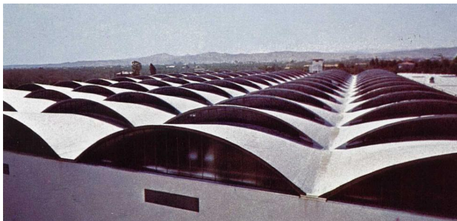
Figura 1.3.1.1: Copertura con volte a shed in laterocemento per uno stabilimento industriale piemontese.
