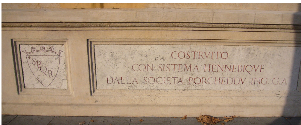
Figura 8.18: Il ponte presenta quattro iscrizioni di questo tipo: due su ogni lato della carreggiata, esse recitano sul lato nord: "Ponte in cemento armato ad un'unica arcata di 100 metri di corda con freccia di 10 metri" e "Costruito con sistema Hennebique dalla società Porcheddu Ing. G.A." mentre sul lato sud: "Inaugurato l'11 maggio del 1911 nel cinquantenario della proclamazione di Roma Capitale d'Italia" e "Dall'amministrazione popolare cittadina al Risorgimento italiano"
