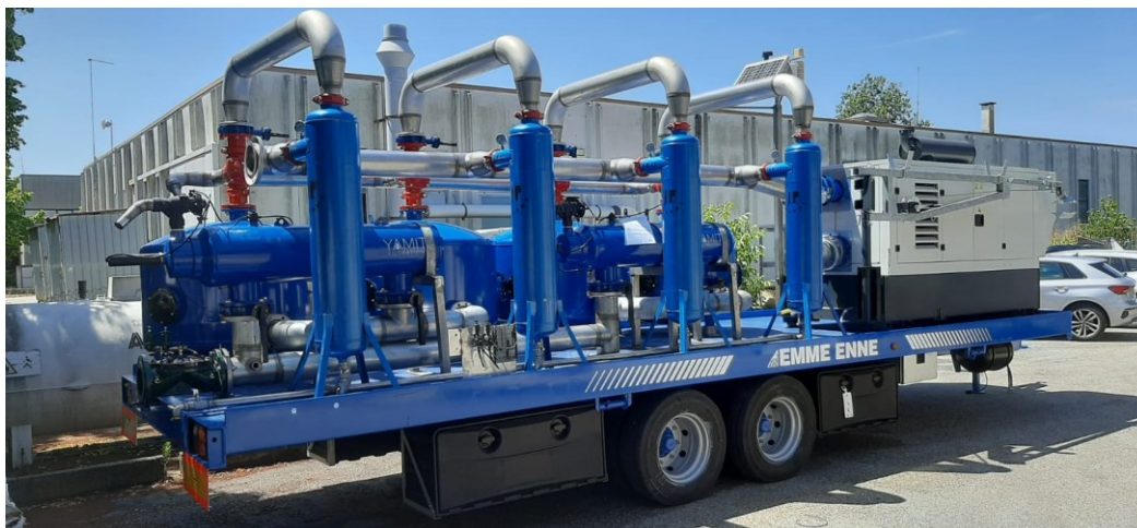
Figura 3.6: Gruppo Pompa e filtri dell'azienda (4)
