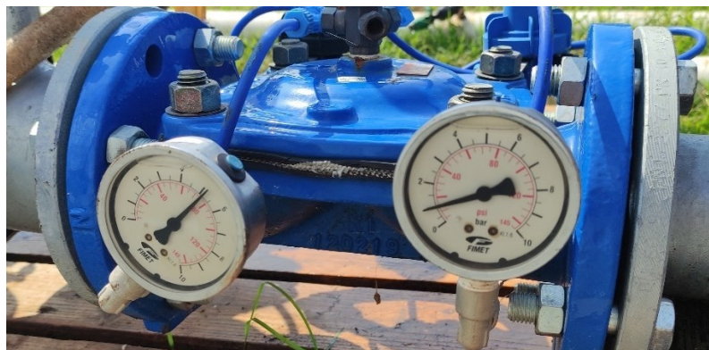
Figure 3.8: Dettaglio della valvola regolatrice di pressione con la pressione in entrata (sinistra) e la pressione in uscita (destra).
