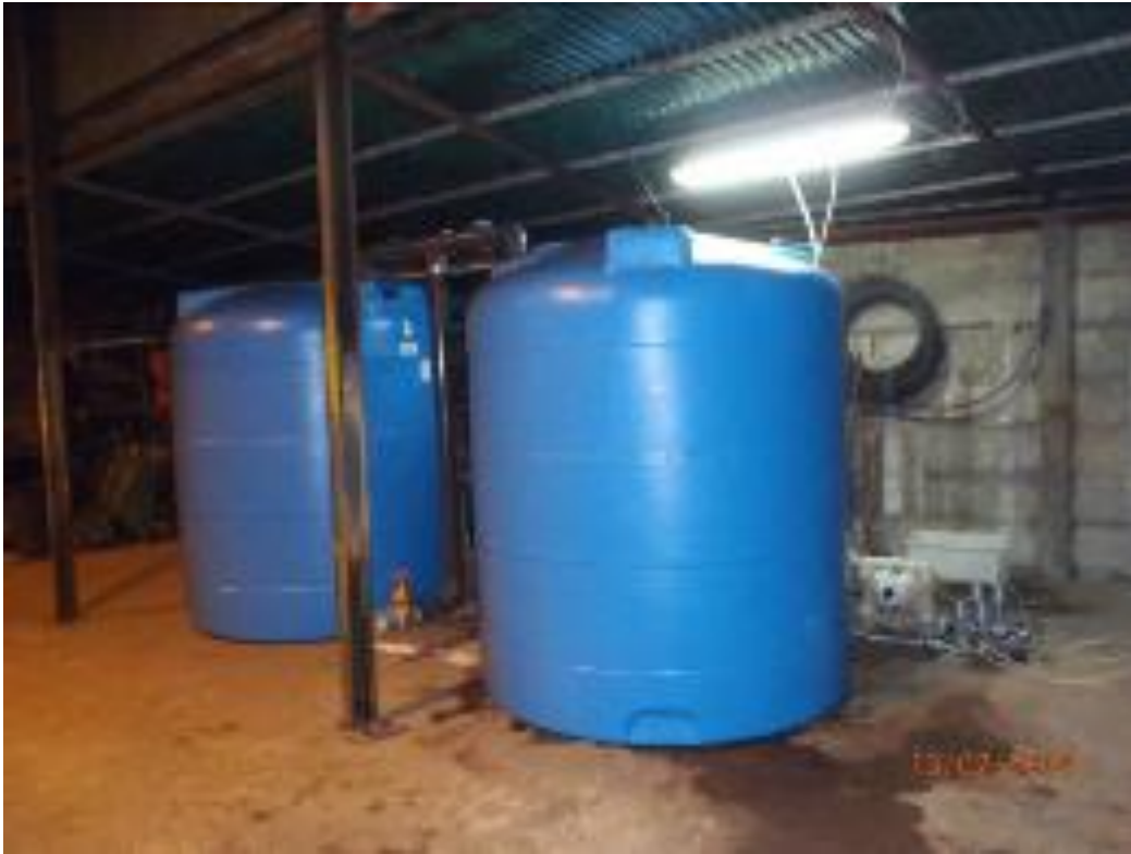
Fig.3.17: Cisterne di stoccaggio dei liquidi aspirati dai piezometri.
