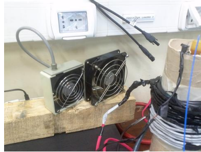
Figura 5.11: Ventole di Raffreddamento
