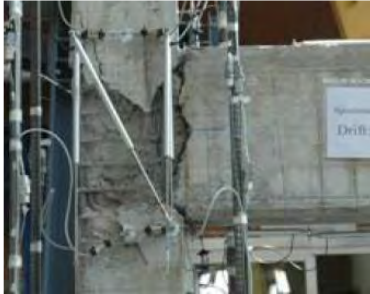
Figura 3.14 Test T5: stato di danneggiamento per drift = 5%.
