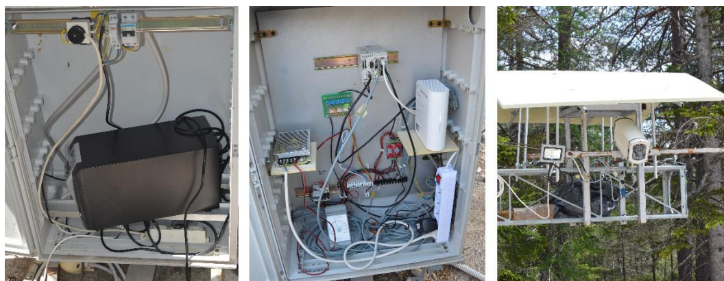
Figura 4.2: Strumentazione della stazione di valle. Da sinistra: l'UPS, l'armadio con il disco rigido, il modem e i collegamenti, la telecamera e il faro.
