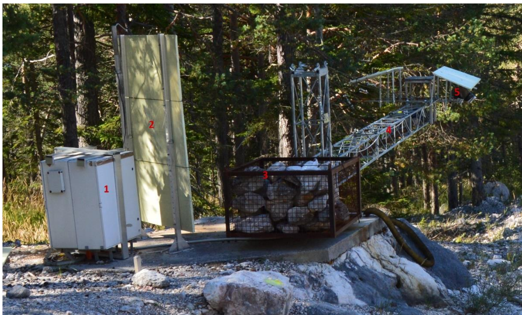
Figura 3.3: La stazione di valle con gli elementi che la compongono. 1: armadio contenente la strumentazione di controllo; 2:ombreggiatore; 3:Cesta di contrappeso; 4:braccio metallico; 5:telecamera.
