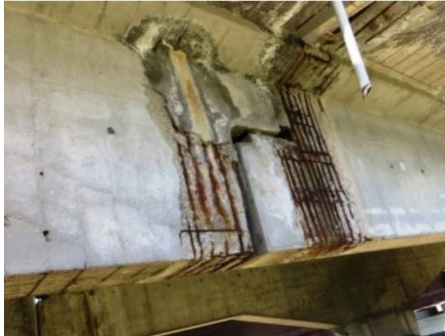
Figura 2.10- Spalling ed esposizione barre corrose
