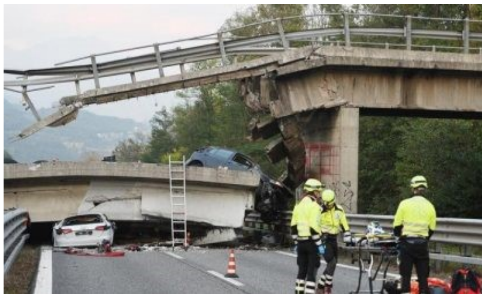
Figura 2.3- Collasso del viadotto ad Annone
