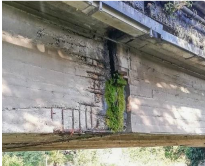
Figura 2.8- Degrado delle selle Gerber, corrosione delle armature e spalling
