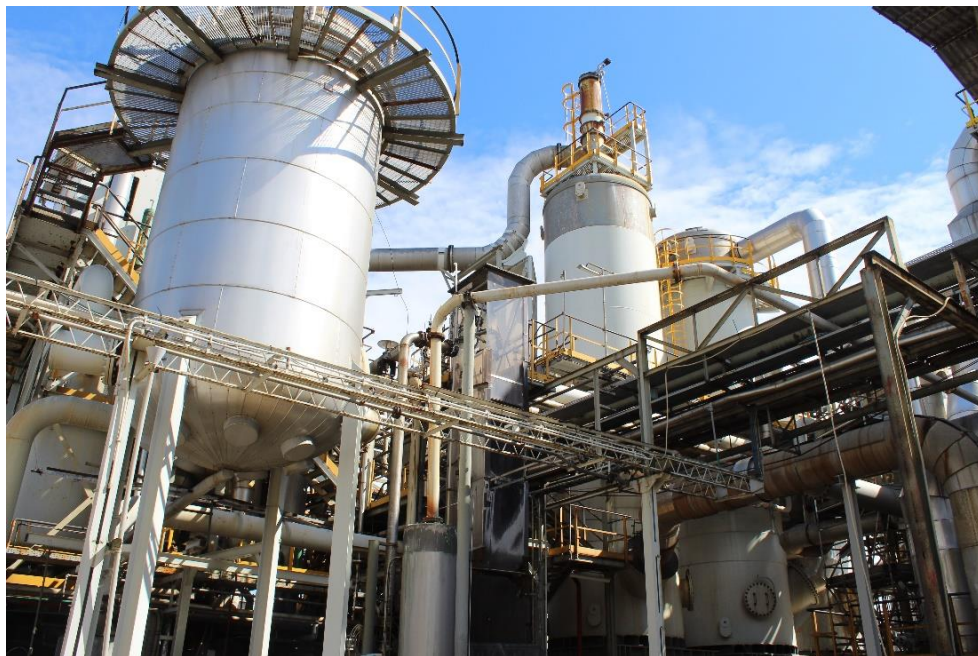
Fig.1 Visione sugli impianti della Marchi Industriale.
