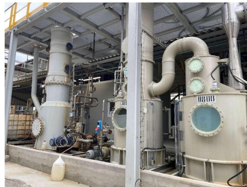
Fig.13 Sistema di abbattimento dell' H 2 S
