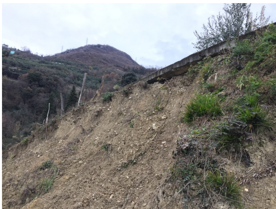
Figura 2.5 Frana superficiale rilevata al di sotto di una sezione della strada, in prossimità della parte superiore dell'area di studio (foto di Luca Mauri)
