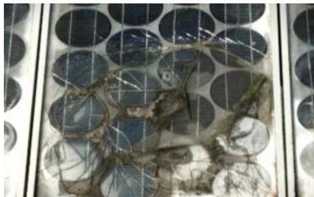
Figura 3.3: Modulo fotovoltaico in cui sono evidenti i danni e l'usura fisica dei suoi componenti
