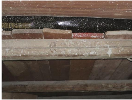
Fig. 4.45: Foto scattata il 28 giugno 2017 che conferma l'assenza della caldaia sopra il tavolato
