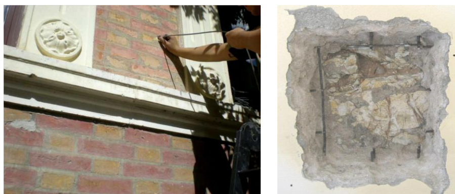
Fig. 4.18: Vista esterna dei mattoni facciavista ed interna delle pietre a spacco di MUR3
