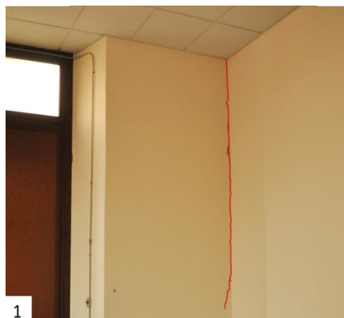
Fig. 4.30: Esempio di lesione verticale tra la parete portante e quella divisoria
