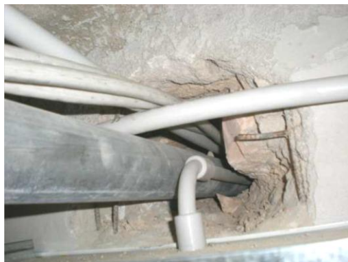
Fig. 4.46: Immagine ottenuta con un saggio conoscitivo dalla società SGM in cui si nota l'assenza del cordolo sul lato del muro interno
