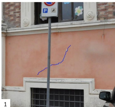
Fig. 4.23: Esempio di lesione sulle fasce di piano
