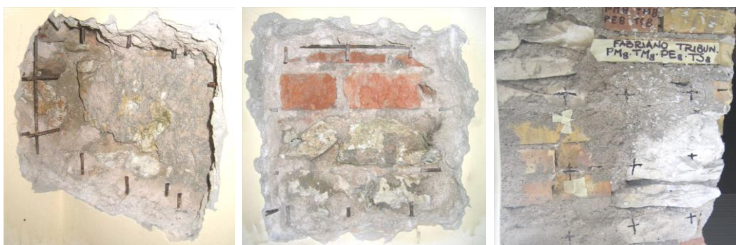
Fig. 4.15: Esempi di MUR1 rilevati rispettivamente al primo piano, al secondo piano e nel sottotetto; si può osservare come i blocchi di muratura appartenenti alla porzione di edificio aggiunta successivamente nel 1950 (secondo piano e sottotetto) siano di dimensioni più ridotte ma con una migliore lavorazione e distribuzione
