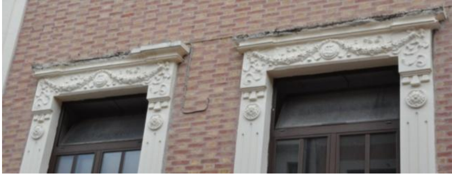
Fig. 4.24: Cornicione superiore delle finestre con espulsione del copri ferro
