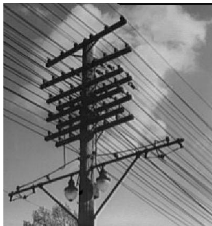
Figura 1.4 cablaggi su cavi
