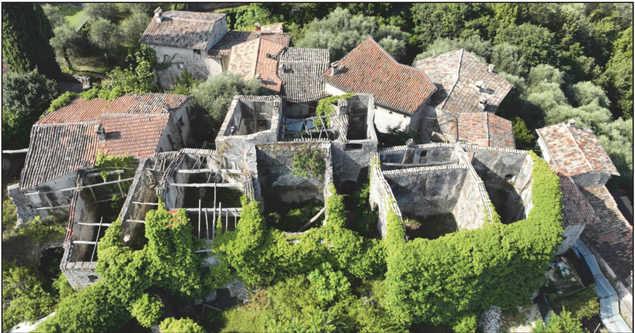
Figura 4 – Aggregato edilizio privo di coperture con conseguente attivazione di fenomeni di degrado delle murature (foto dell'autore 2025).
