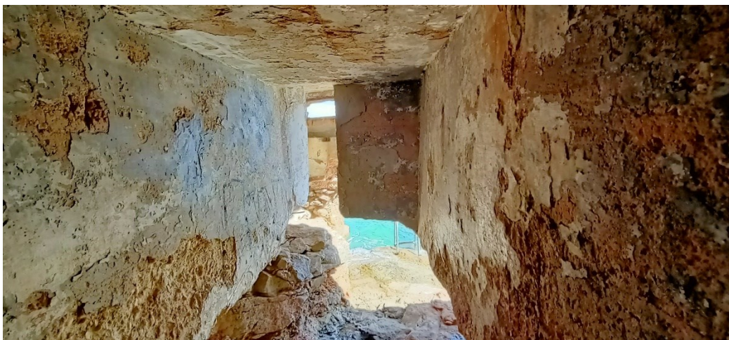
Figura 26 – Tracce di erosione e colore su pillbox (Foto dell'autore, 2024)
