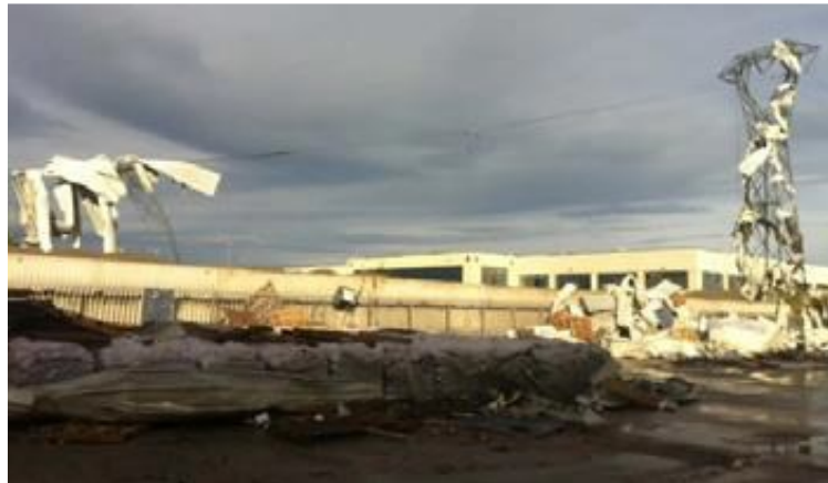
Guasto linea 380 kV causato da una tromba d'aria, Trezzo d'Adda 2017
