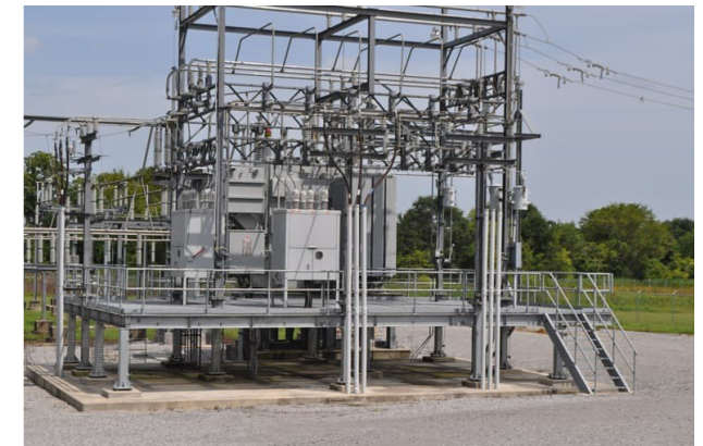
Sottostazione elevata progettata per ridurre il danno provocato da inondazione
