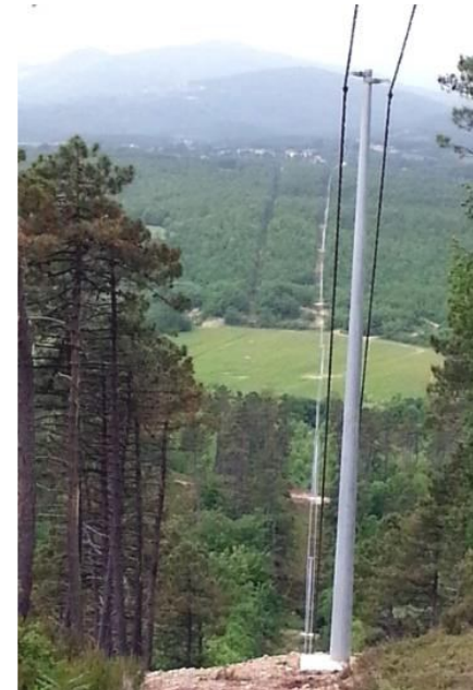
Conduttura elettrica con fascia di asservimento
