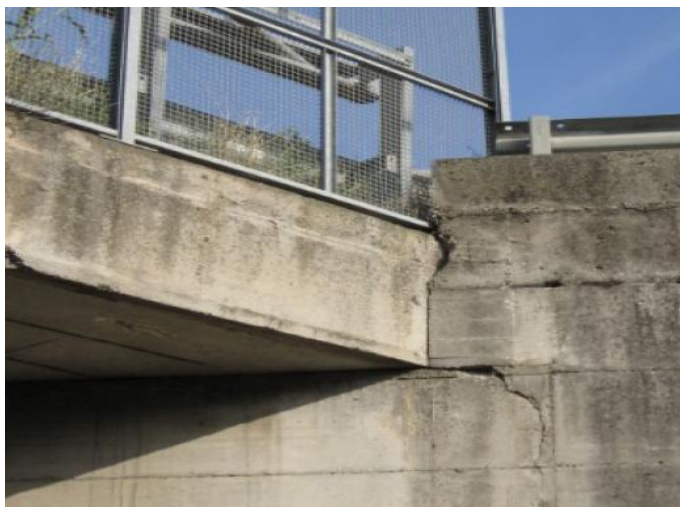
Figura 10.7: "Particolare del giunto con presenza di fessure estese"
