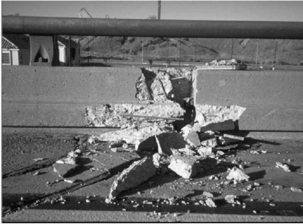
Figura 3.4: “Martellamento tra due sezioni d’implacato per effetto dell’errato dimensionamento del giunto strutturale”
