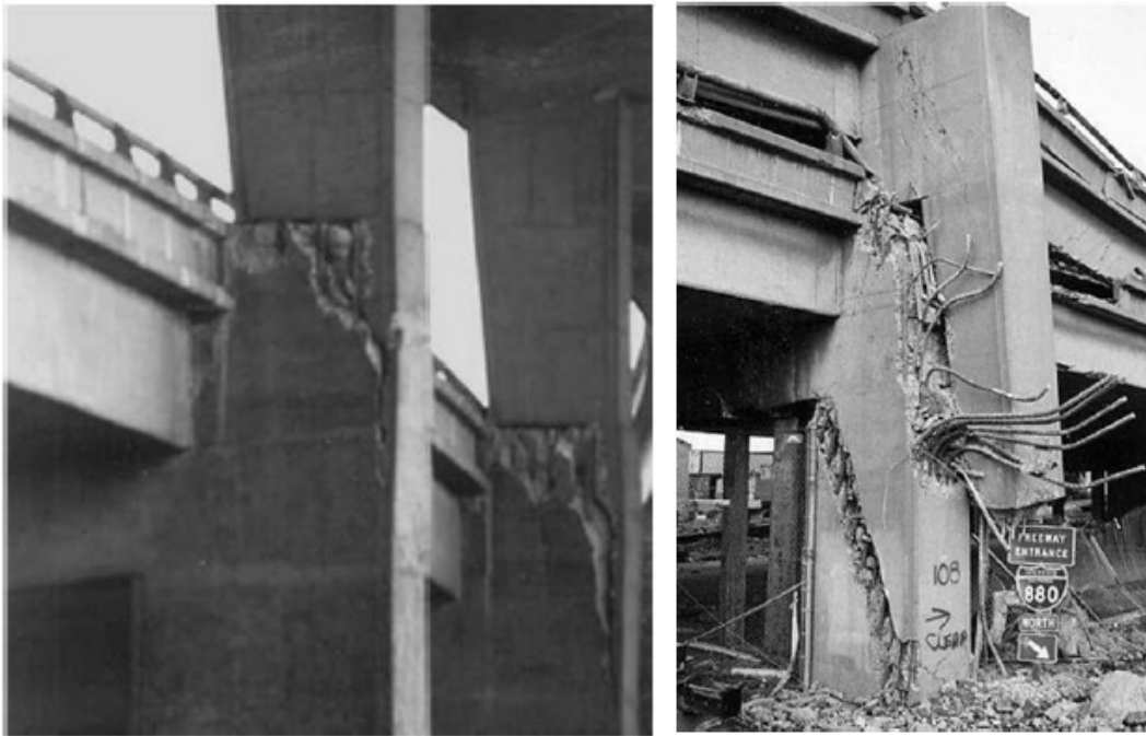
Figura 3.6: “Rottura per taglio delle pile - Terremoto Loma Prieta (California) 1989”
