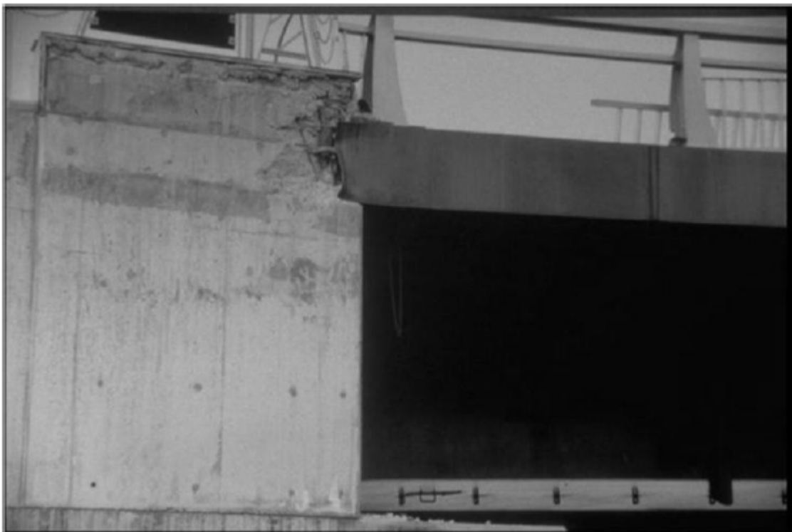
Figura 3.3: “Martellamento della sovrastruttura contro la spalla”
