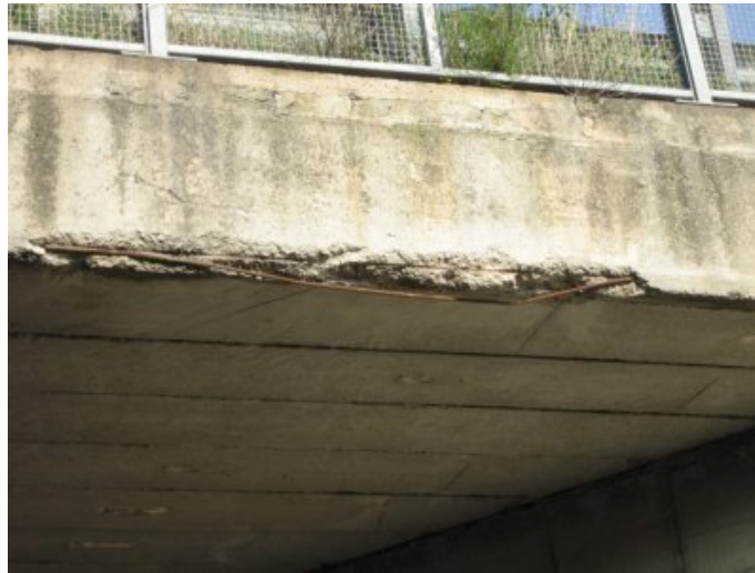
Figura 10.6: "Particolare della soletta con distacco del copriferro ed esposizione delle barre di armatura"
