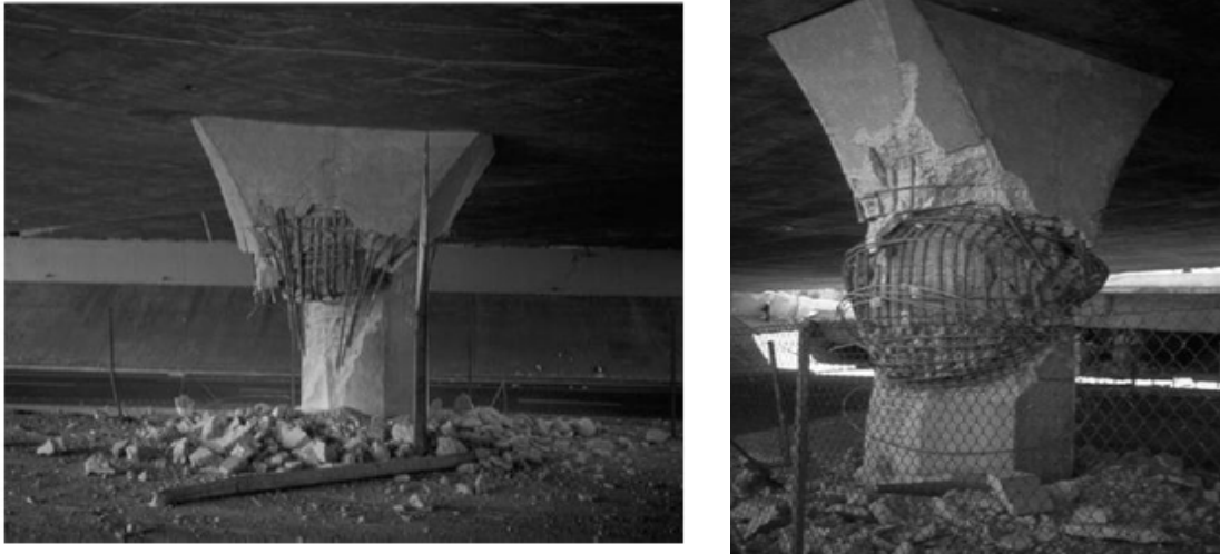
Figura 3.8: “Rottura e conseguente schiacciamento delle pile - Terremoto Northridge (California) 1994”
