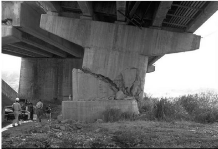
Figura 3.9: “Rottura per taglio delle pile ed incipiente ribaltamento - Terremoto Chi-Chi (Taiwan) 1999”
