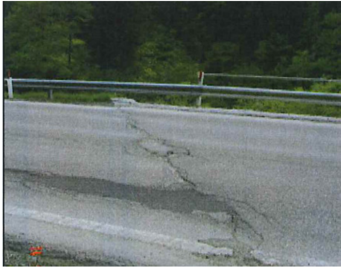
Figura 10.12: "Particolare della pavimentazione stradale con usura evidente"
