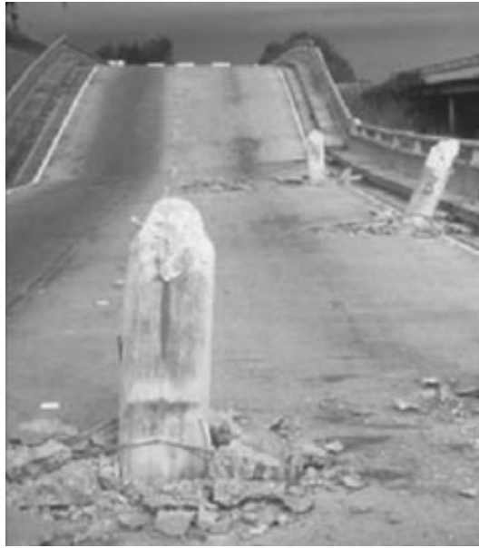
Figura 3.10: “Punzonamento di una pila attraverso la sede stradale della Route 1, nell’area di Watsonville, durante il terremoto di Loma Prieta del 1989”
