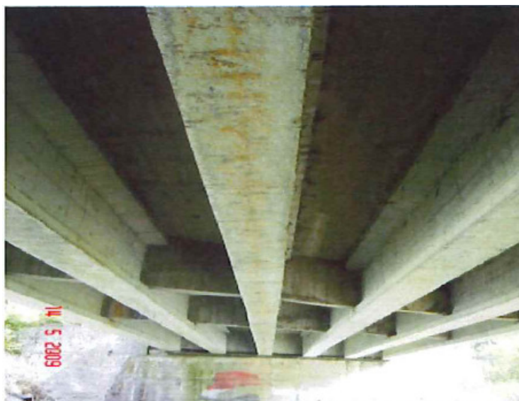
Figura 10.10: "Particolare dello stato di degrado di una singola trave"
