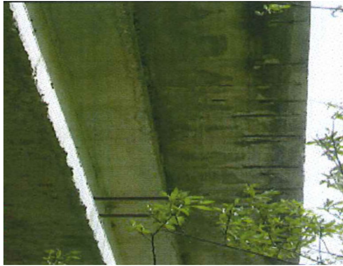
Figura 10.16: "Particolare dell'intradosso della soletta dell'impalcato che presenta estesa fessurazione e barre scoperte"
