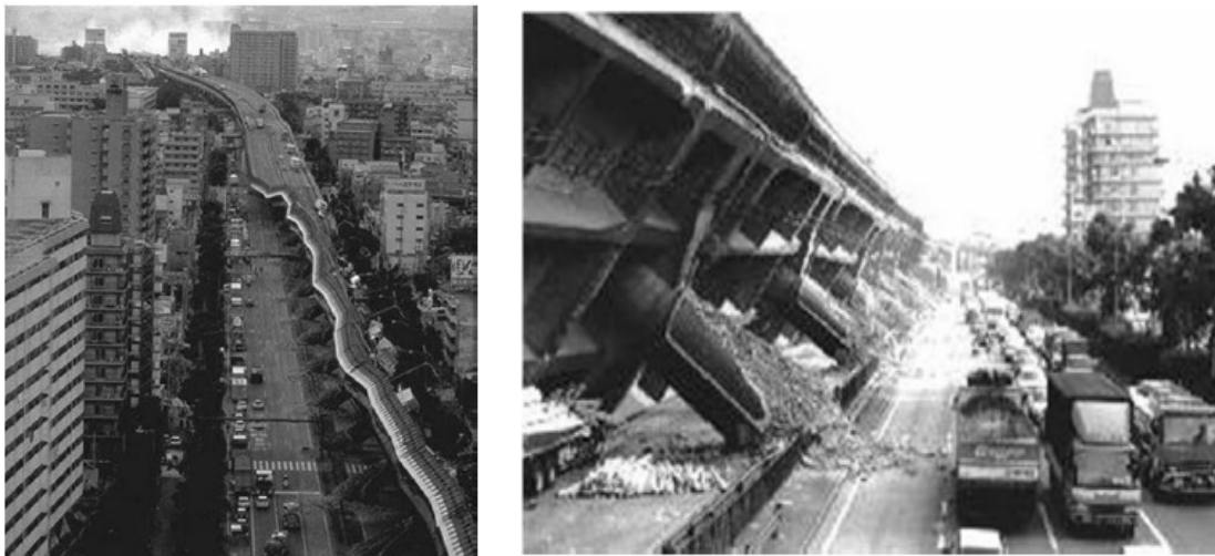
Figura 3.7: “Rottura per flessione delle pile - Terremoto Kobe (viadotto Fukae) 1995”
