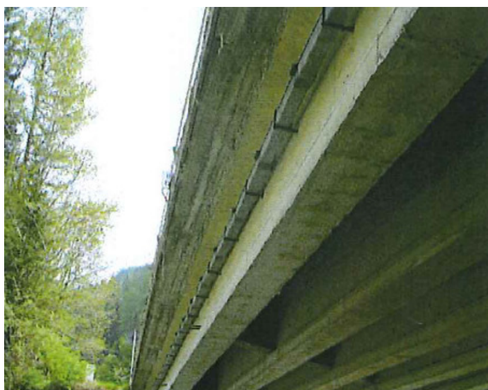
Figura 10.15: "Particolare dello stato delle travi che reggono la soletta"
