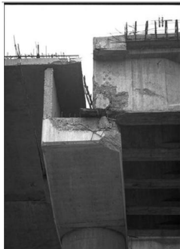
Figura 3.1: “Lunghezza inadeguata delle sedi di appoggio”
