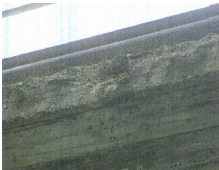
Figura 10.18: “Particolare del cordolo evidentemente danneggiato”
