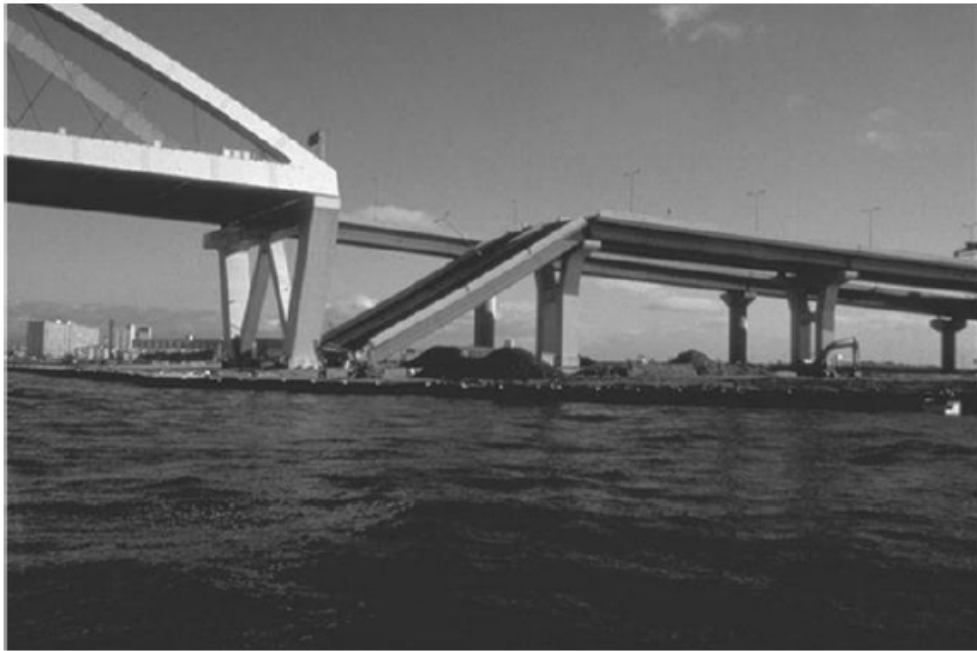
Figura 3.2: “Perdita di appoggio con scivolamento dell’impalcato”
