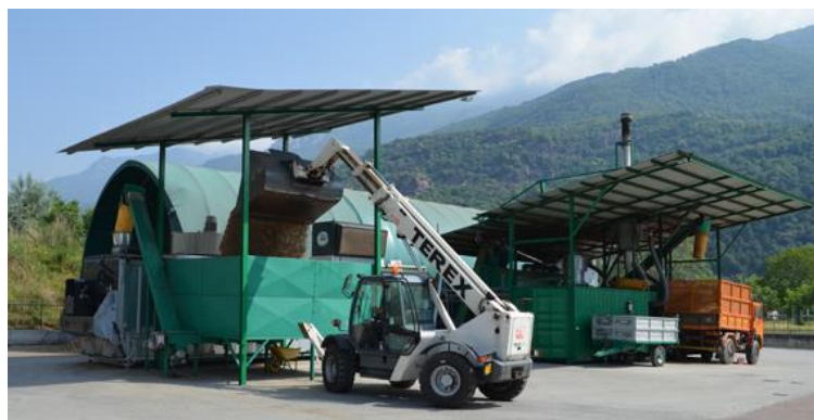
Figura 4-5 Impianto di essiccazione e vagliatura del cippato. Fonte Caldaie Cippato Torino
