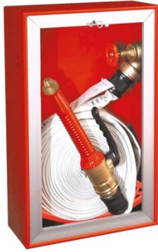
c) idrante a muro
