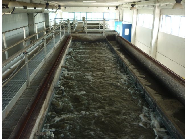
Fig. 3.4: Stazione di dissabbiatura-disoleatura.
