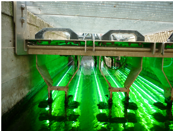
Fig. 3.9: Dettaglio stazione di disinfezione raggi UV.
