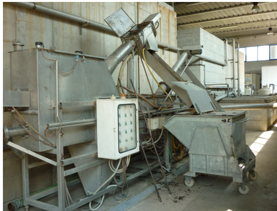
Fig. 3.2: Stazione trattamento bottini.
