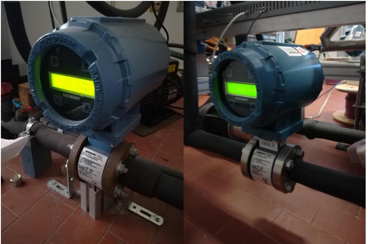
Figura 3.18: Misuratori elettromagnetici di portata. A sinistra quello installato nel ramo ad acqua per l'alimento del precondensatore, a destra quello installato nel ramo per l'acqua di alimento all'evaporatore.
