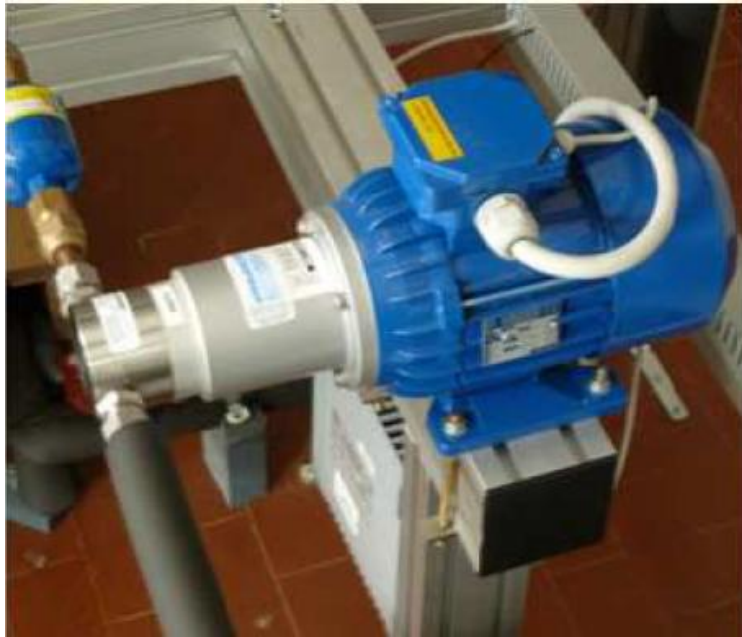
Figura 3.5: Pompa modello GC M25. Nella parte bassa si può notare l'inverter per la regolazione della velocità di rotazione.[7]
