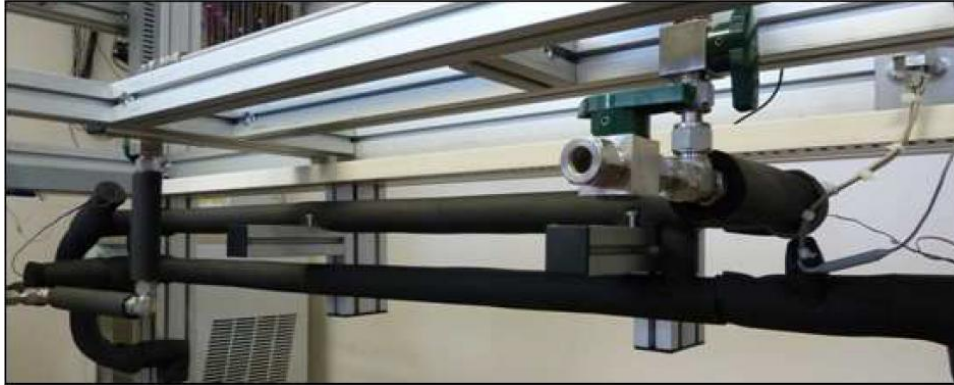
Figura 3.10: Precondensatore tubo in tubo installato [7]
