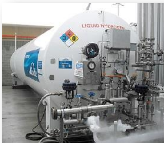
Figura 16: Bombola per lo stoccaggio dell'idrogeno liquido
