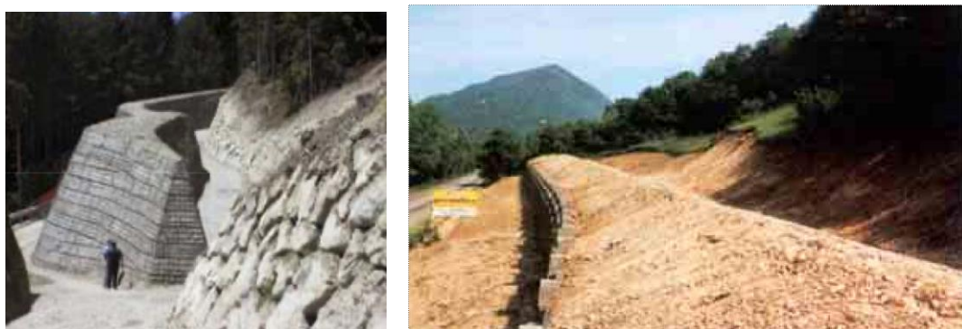
Fig.26 – esempio di rilevato paramassi a sinistra e vallo paramassi con parete sostenuta da muro cellulare a destra.
