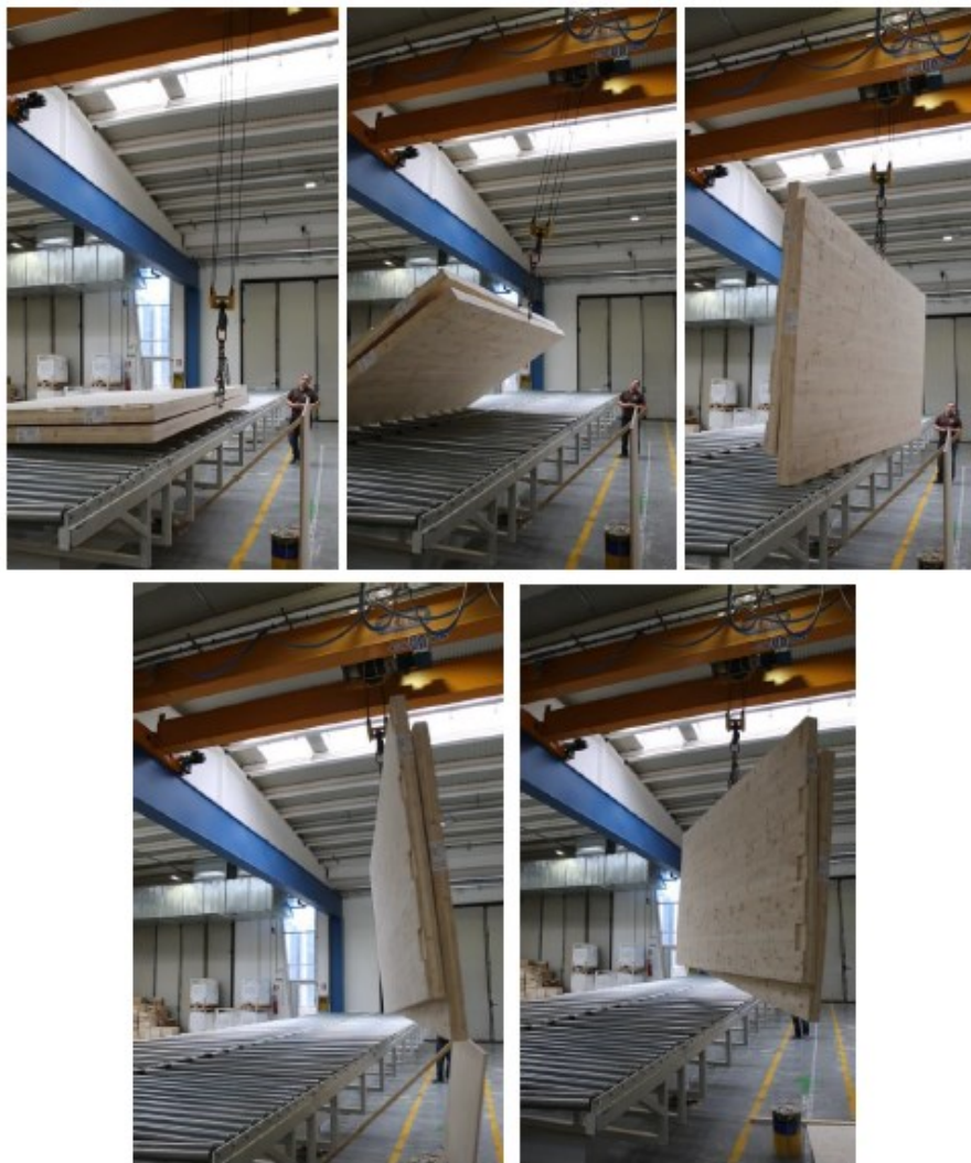
Figura 5.7. Ricostruzione operazione di sollevamento il giorno dell'incidente
