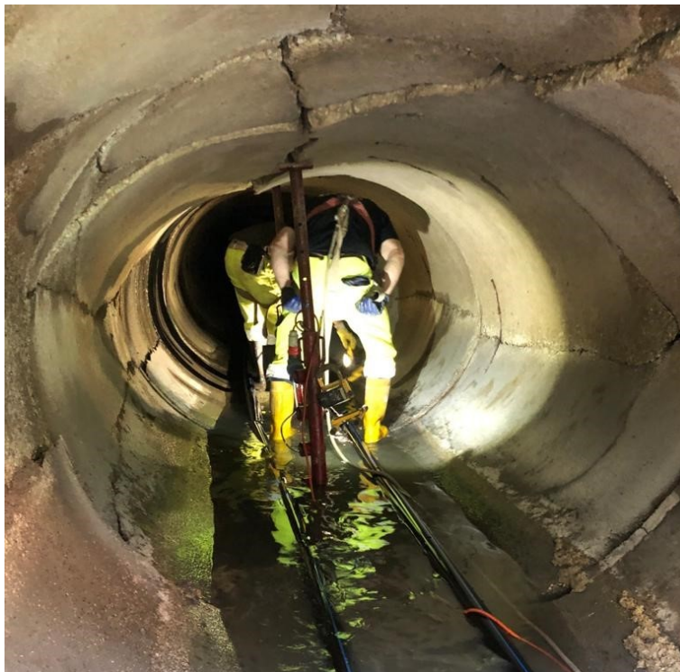
Figura 6-cedimento strutturale di un collettore di fogna presso str. di Longara (VI), fonte Viacqua spa
