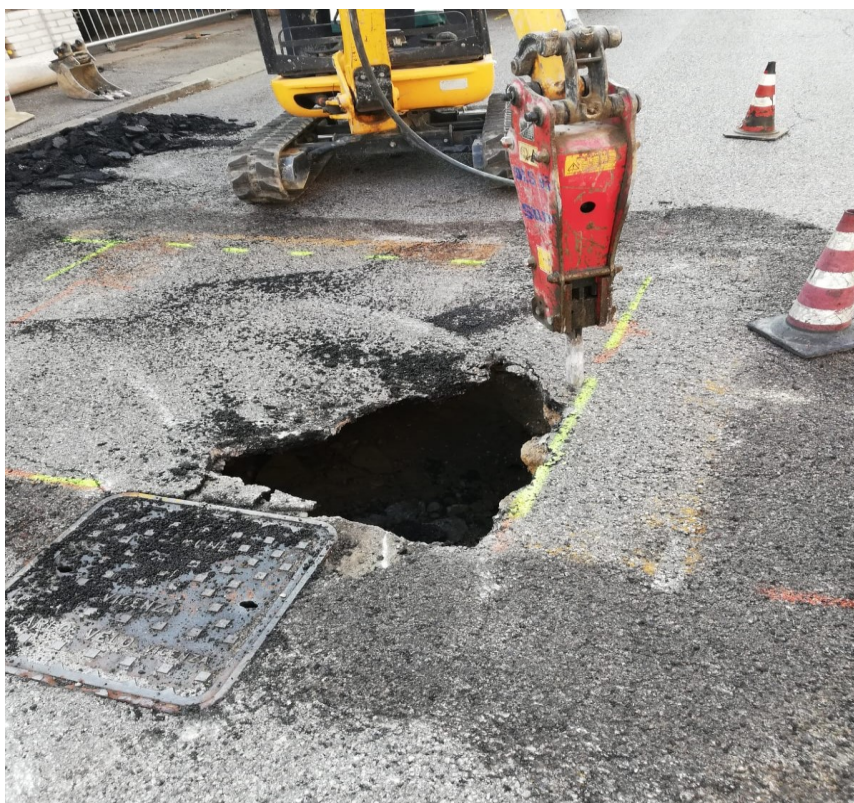
Figura 30- Voragine fognaria in Via Parini (VI), fonte Viacqua spa
