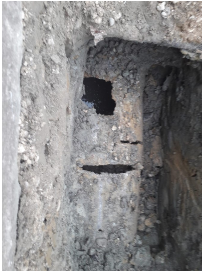
Figura 5- crollo della volta fognaria di una tubazione, fonte Viacqua spa
