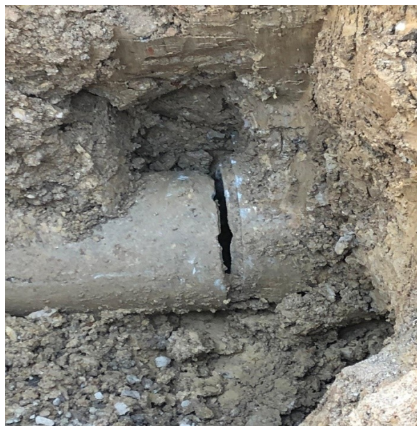
Figura 7- Rottura del giunto tra tubazioni in Via E.Toti (VI), fonte Viacqua spa
