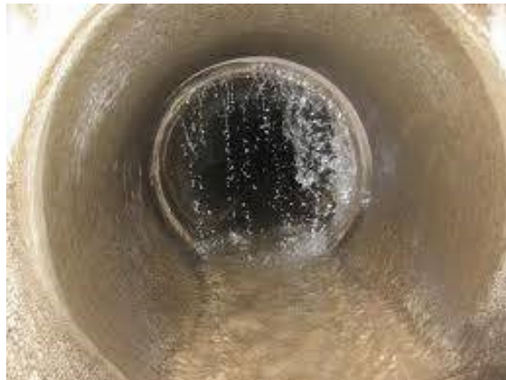
Figura 3- infiltrazione di acque parassite in fognatura ( https://www.ingenio-web.it )
