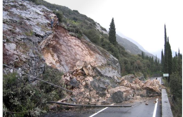
Figura 1: frana di circa 150 m 3 sulla S.S. n. 249 Gardesana orientale, nel territorio comunale di Nago Torbole (TN) (fonte: Protezione Civile Trentino)
