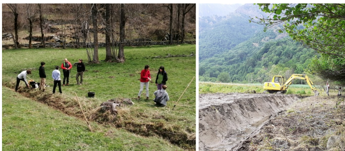
Figura 15. Interventi di manutenzione dei fossi di scolo esistenti e realizzazione di nuove canalizzazioni per la regimazione delle acque superficiali, sui terreni gestiti da AsFo La Chiara; Fonte: AsFo La Chiara, 2026
